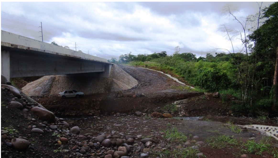
Figura 41: Vista lateral (sentido Oeste-Este) donde se muestra la escollera del bastión-este. Puente sobre Quebrada Campamento.
