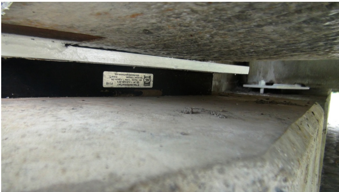
Figura 38: Apoyo con almohadilla de neopreno proporcionada por la Hulera Costarricense. Puente sobre la Quebrada Pericos.
