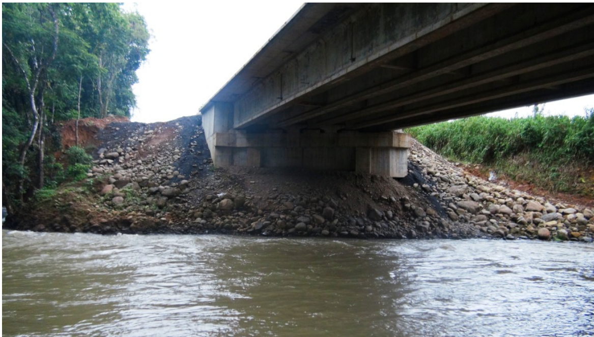
Figura 6. Falta construir la escollera de protección para el Bastión-Oeste. Puente sobre el Rio Sandillal.
