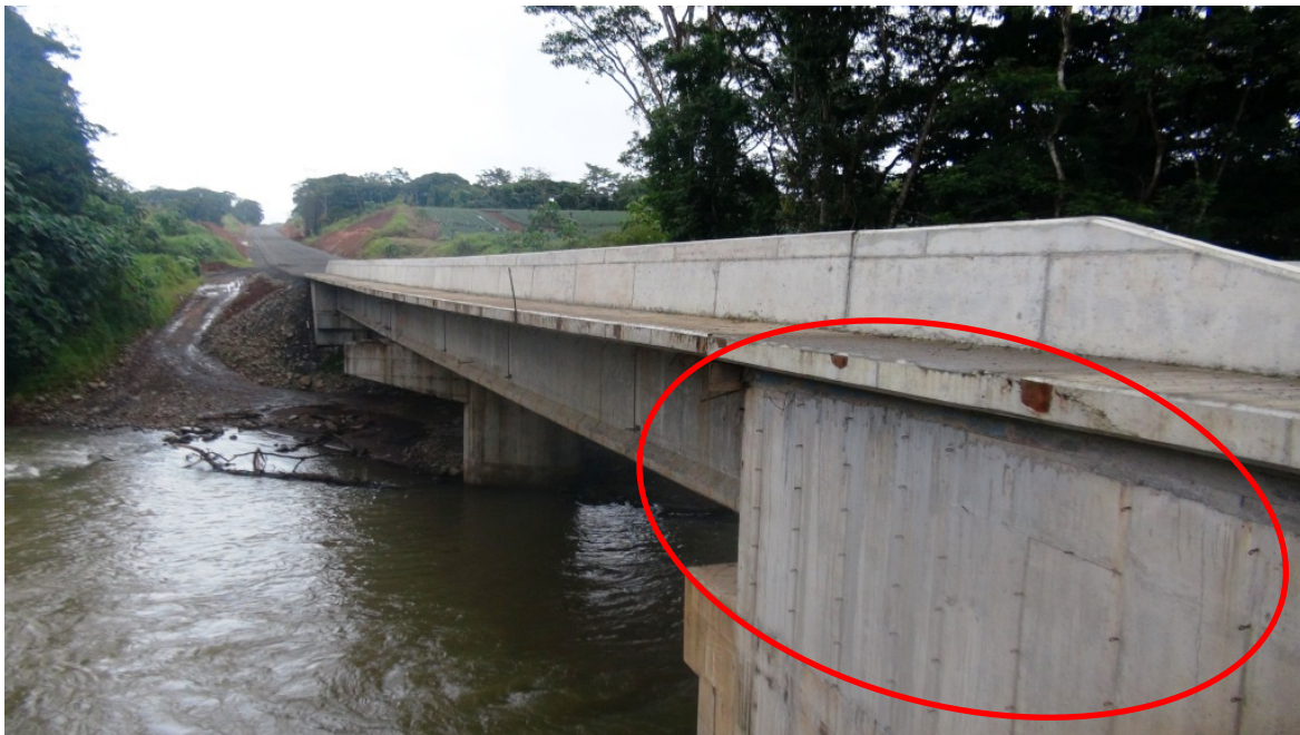
Figura 3. Vista lateral del puente (sentido Oeste a Este) donde se observa los alambres que sobresalen del aletón. Puente sobre el Río Sandillal.
