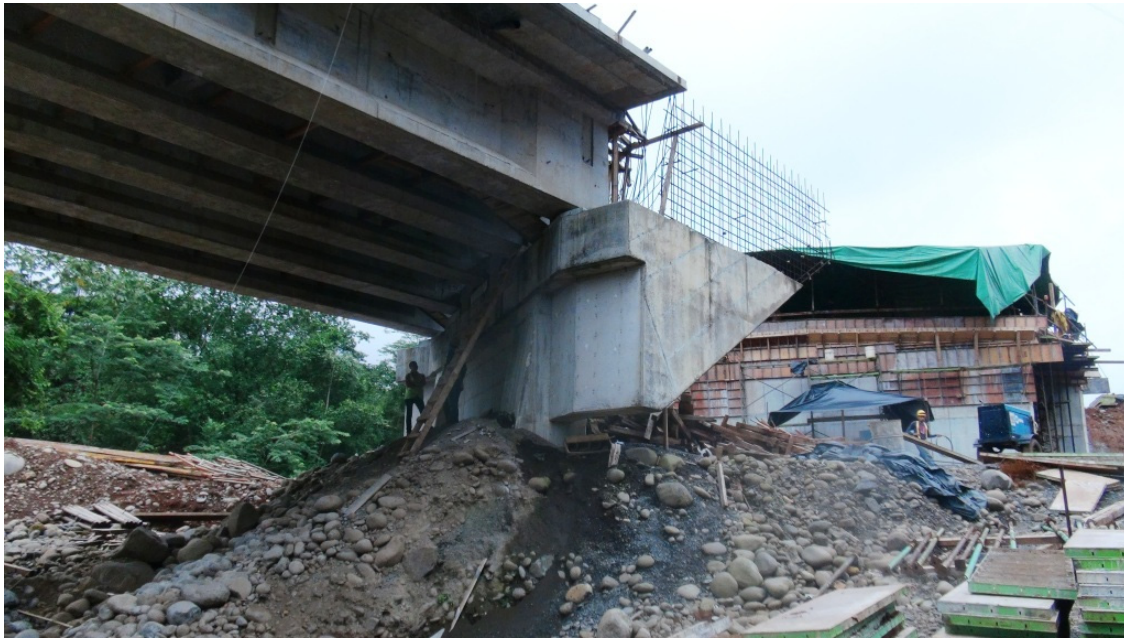
Figura 11. Falta completar la construcción de los aletones, la pared de la viga cabezal y la viga diafragma, losa de aproximación para el bastión Oeste. Al fondo se observa la construcción del paso inferior para una carretera existente perpendicular a la vía principal. Puente sobre el Rio Cuarto.
