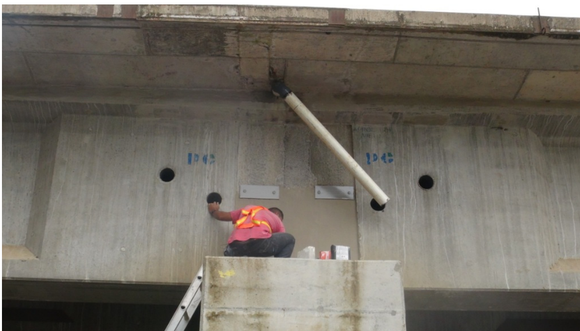
Figura 26. Protección de la placa de anclaje de las vigas diafragma y acabado de la superficie. Puente sobre el Río Toro.
