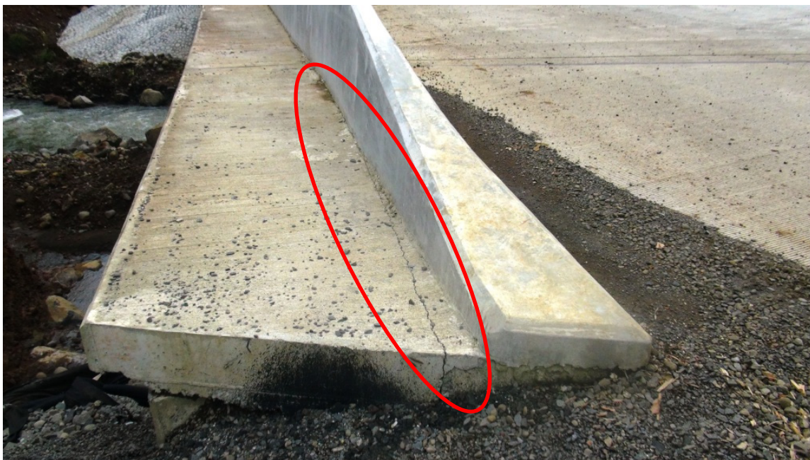
Figura 18. Grieta longitudinal en el remate de acera del bastión Oeste (costado norte). Puente sobre el Río Caño Negro.
