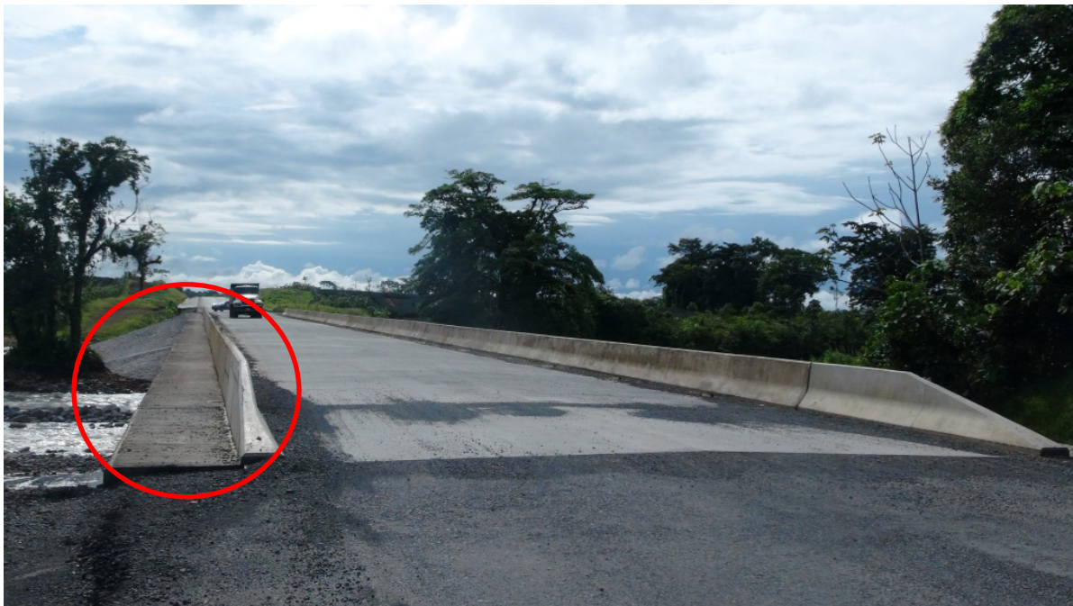
Figura 21. Vista del la línea de centro mostrando la falta de baranda vehicular. La barrera vehicular tampoco presenta juntas de construcción en su longitud. Puente sobre el Rio Toro.
