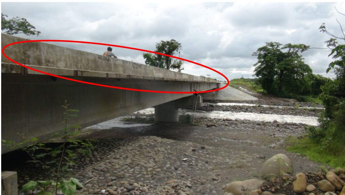
Figura 22: Vista lateral mostrando la falta de baranda peatonal. La barrera vehicular no presenta juntas de construcción a lo largo de la misma. Puente sobre el Rio Toro.
