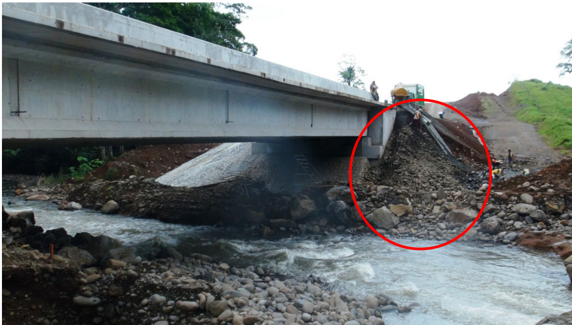
Figura 19. Escollera del Bastión - Este en construcción. Puente sobre el Rio Caño Negro.
