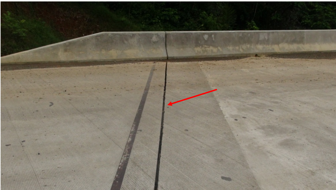
Figura 16. Falta colocar el sello de hule en ambas juntas de expansión. Puente sobre el Río Caño Negro.
