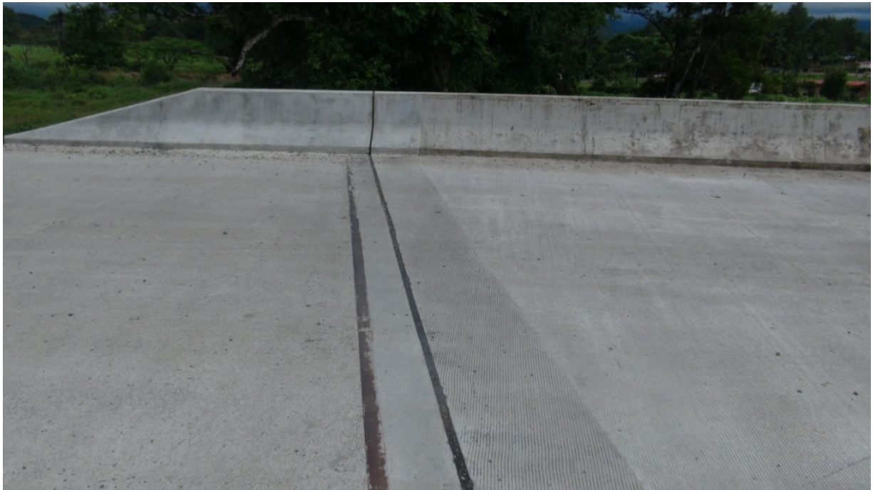
Figura 34: Faltaba colocar el sello de la junta de expansión. Puente sobre la Quebrada Pericos.
