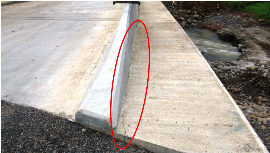
Figura 17. Grieta longitudinal en el remate de acera del bastión Oeste (costado sur). Puente sobre el Río Caño Negro.
