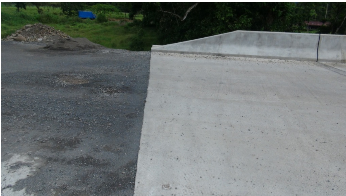
Figura 35: Se observa desprendimiento del concreto de la losa de de aproximación en contacto con la carpeta asfáltica. No cuenta con angular de protección. Puente sobre la Quebrada Pericos.
