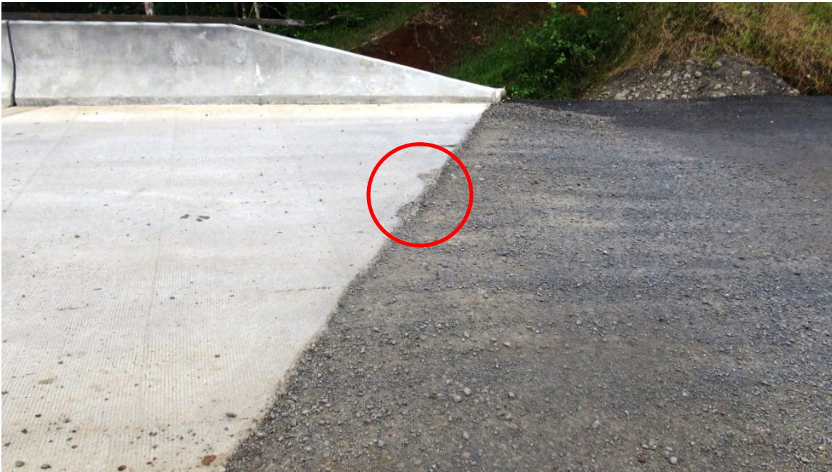
Figura 15. Desprendimiento de concreto en el borde de la losa de aproximación. Puente sobre el Río Caño Negro.
