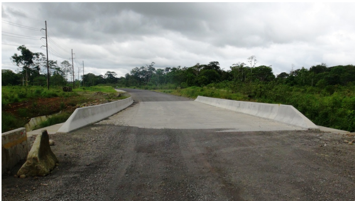
Figura 39: Vista de la línea de centro mostrando la falta de la baranda peatonal. Puente sobre Quebrada Campamento.
