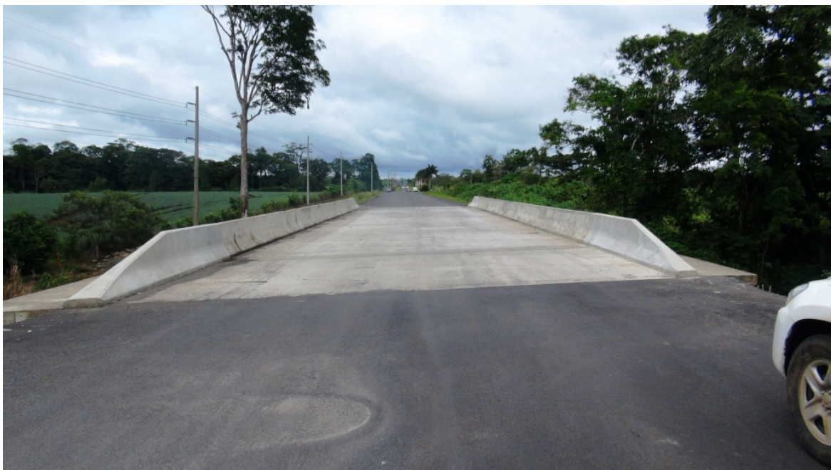
Figura 32: Línea de centro del puente donde se muestra la falta de baranda peatonal. Puente sobre Quebrada Pericos.
