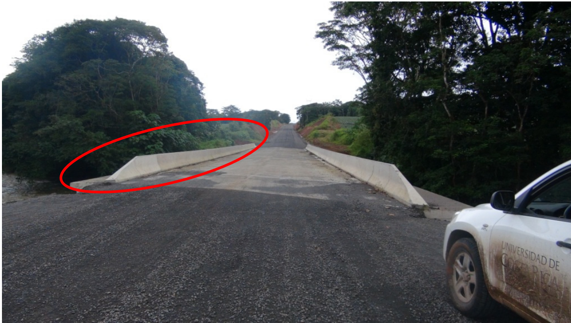
Figura 2. Vista a lo largo de la línea de centro (sentido Oeste a Este) donde se observa la falta de la baranda vehicular. Puente sobre el Río Sandillal.
