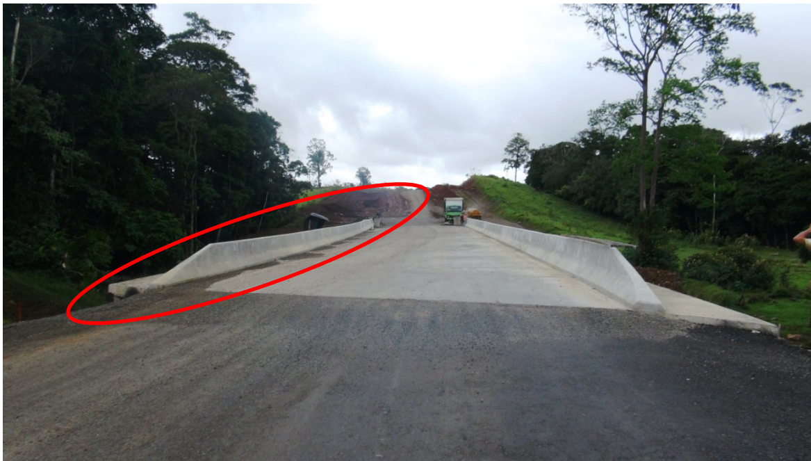
Figura 13. Vista en el sentido Oeste-Este mostrando la falta de la baranda peatonal. Puente sobre el río Caño Negro.
