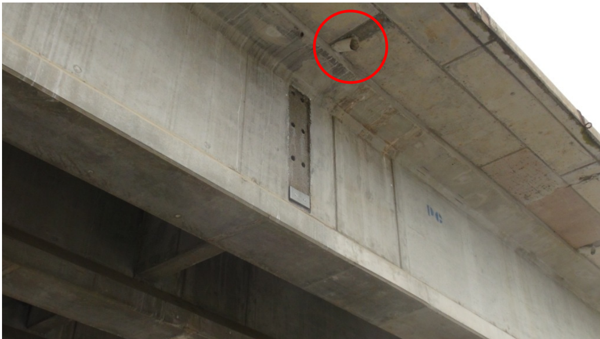
Figura 23. No se ha completado el anclaje con placas del acero de refuerzo de la vigas diafragma a la viga exterior del puente . Puente sobre el Río Toro.
