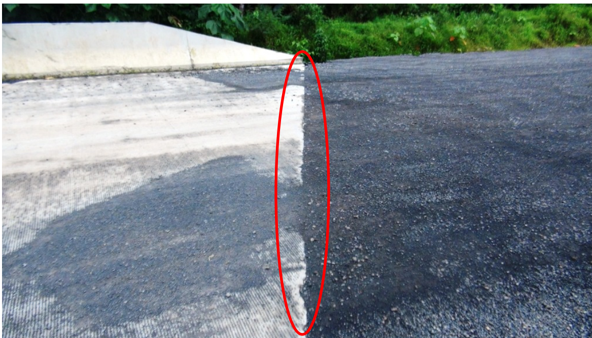
Figura 8. Desprendimiento del concreto en el filo de la losa de aproximación. Puente sobre el Rio Sandillal.
