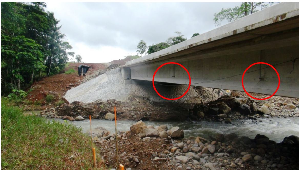
Figura 14. Vista lateral del puente (costado norte) mostrando que aun falta anclar el acero de refuerzo que sobresale de las vigas diafragma. Puente sobre el Río Caño Negro.
