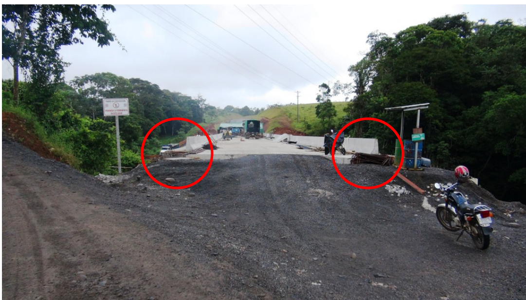
Figura 9. Vista a lo largo de la línea de centro (sentido Este-Oeste) donde se observa la falta de baranda vehicular y los segmentos de la barrera vehicular en el acceso de aproximación. Puente sobre el Río Cuarto.
