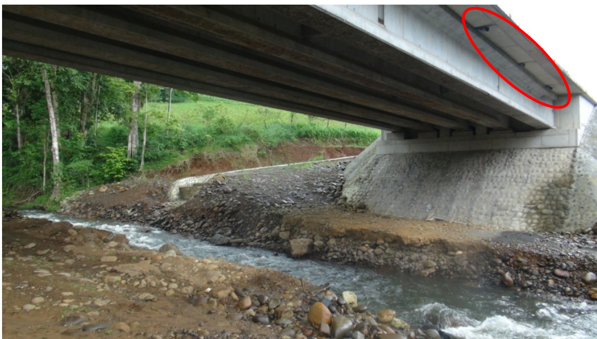
Figura 42: Vista bajo el puente (sentido Este-Oeste) donde se muestra la falta de longitud de los tubos de desagüe de la calzada. Puente sobre Quebrada Campamento.
