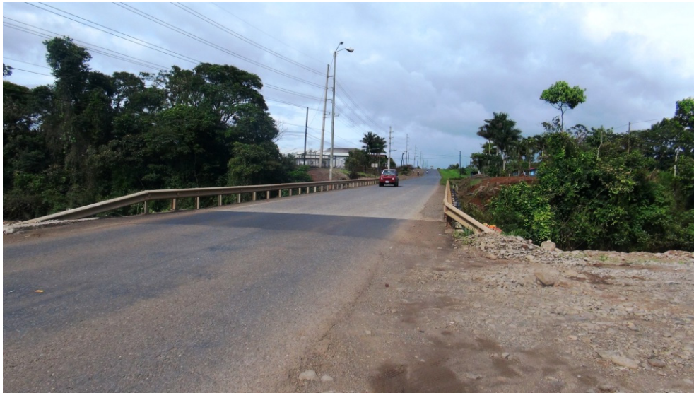
Figura 30. Se observó juntas de expansión sin sello, asentamiento de los accesos de aproximación y desprendimiento del concreto de la pared del cabezal. Puente sobre el Río Tres Amigos.
