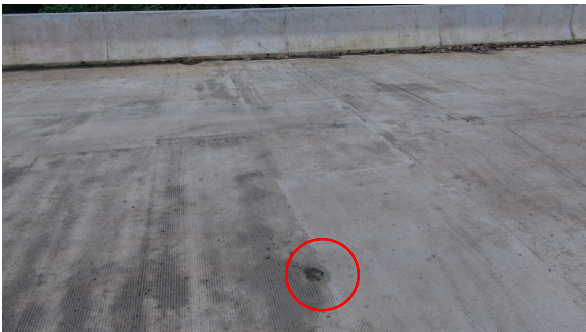
Figura 7. Descascaramiento localizado del concreto en la losa de aproximación. Puente sobre el Rio Sandillal.
