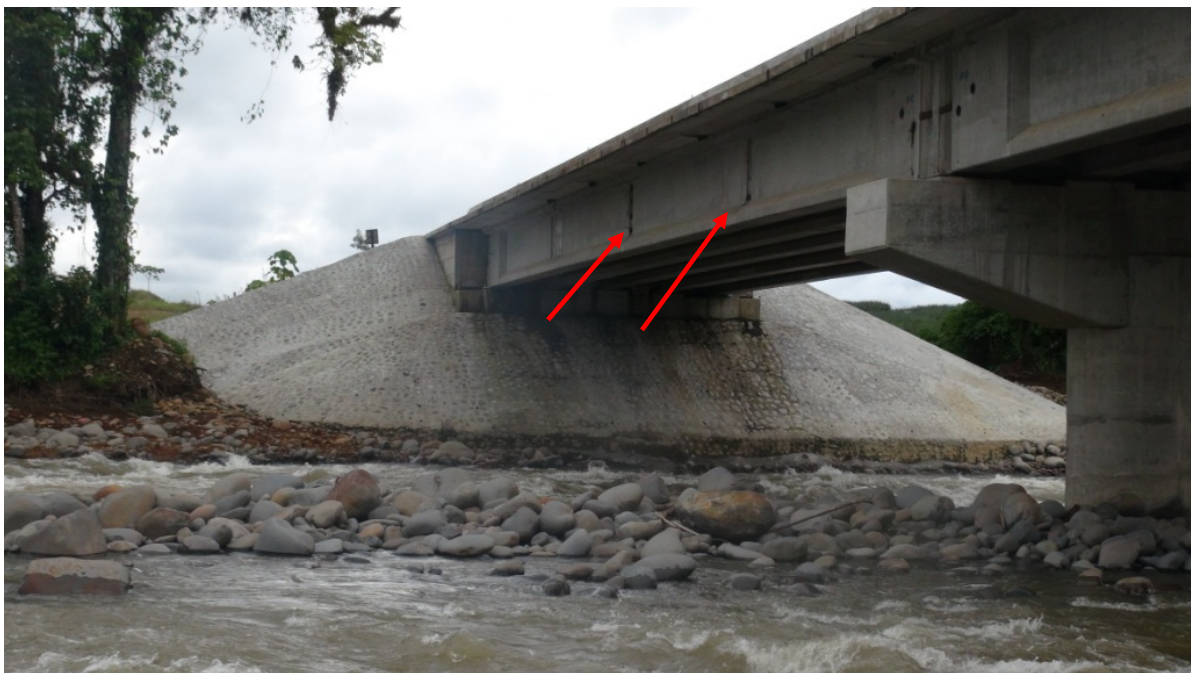
Figura 24. Ya está construida la escollera del bastion Oeste. Falta colocar la placa de anclaje en varias vigas diafragma (costado sur). Puente sobre el Río Toro.
