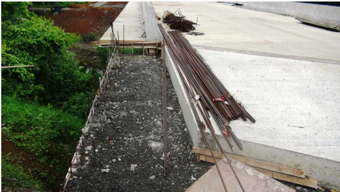
Figura 12. Falta construir la losa de la acera del acceso de aproximación Este. Puente sobre el Rio Cuarto.
