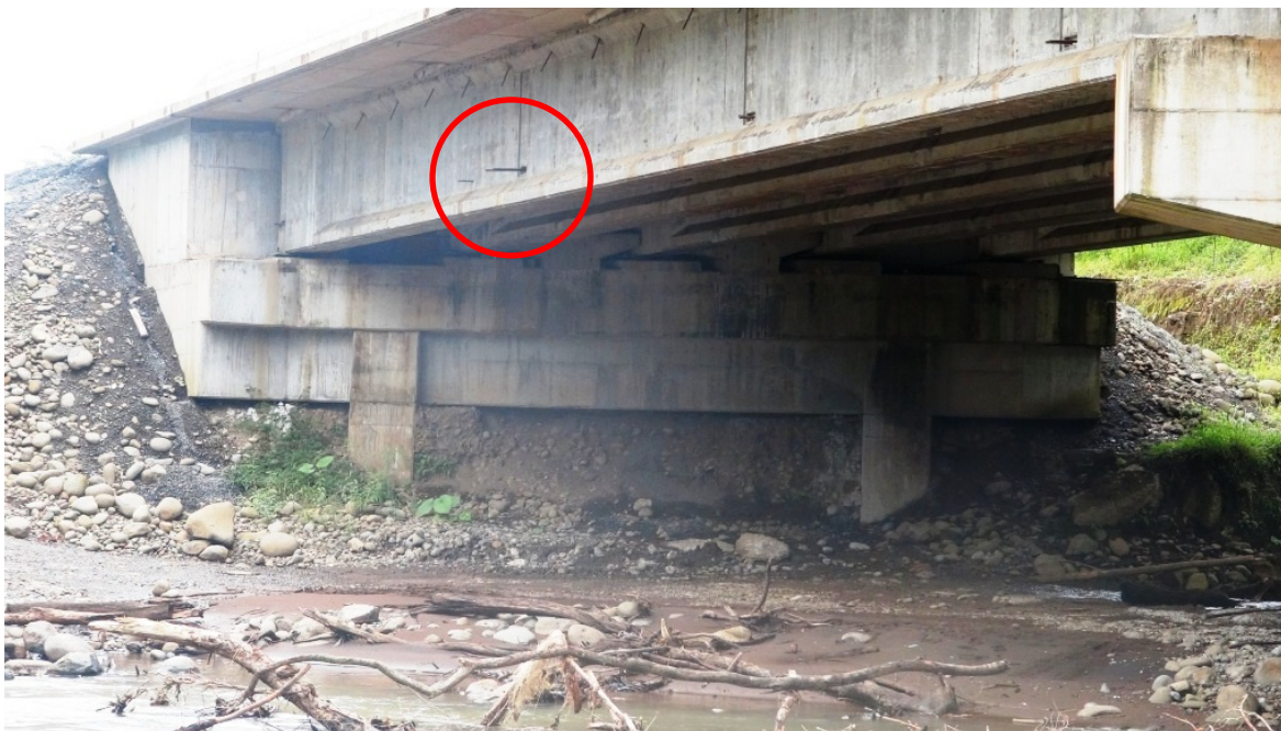
Figura 5. Falta construir la escollera de protección del Bastión-Este. Puente sobre el Río Sandillal.
