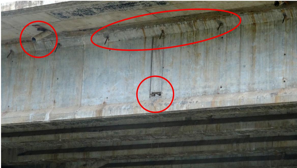
Figura 4. Acero de refuerzo que sobresale de la viga exterior y longitud insuficiente de los tubos de desagüe. Puente sobre el Río Sandillal.
