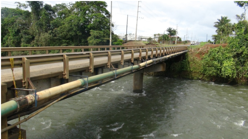
Figura 31. Se observó acumulación de sedimento y humedad alrededor de los apoyos y además corrosión de vigas principales y sus respectivos apoyos mecánicos. Puente sobre el Río Tres Amigos.
