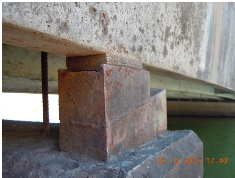
Figura 12: Oxidación y corrosión de los apoyos y agrietamiento de los neoprenos de las vigas exteriores.
