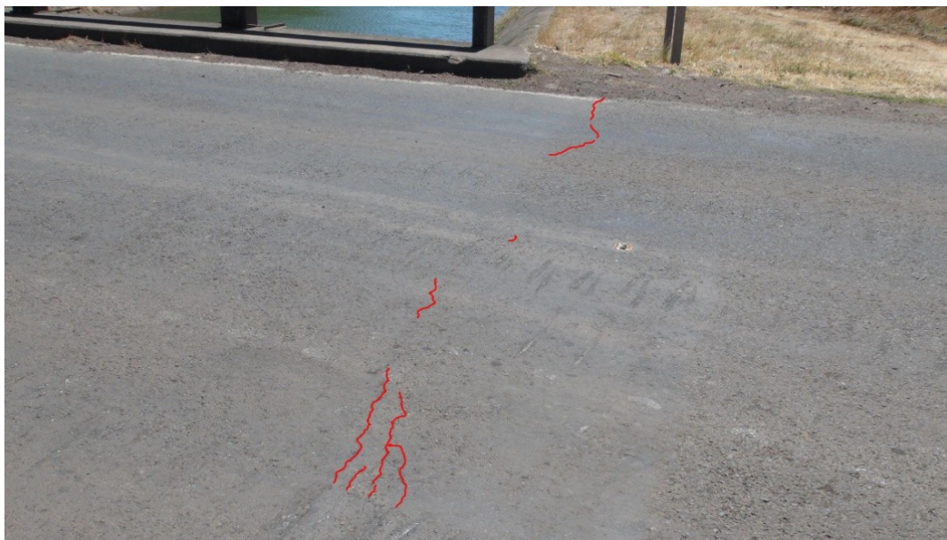
Figura 9: Grieta transversal en el pavimento en el acceso sur, justo donde comienza el puente.
