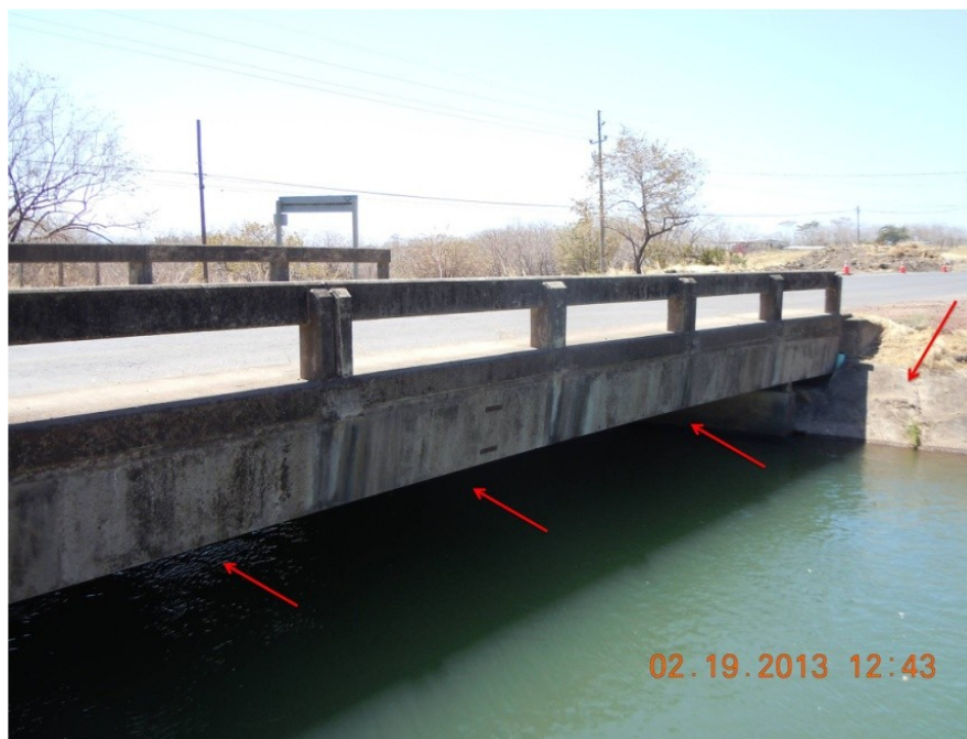
Figura 7: Falta de sistema de drenaje en el acceso norte y en la losa del puente.
