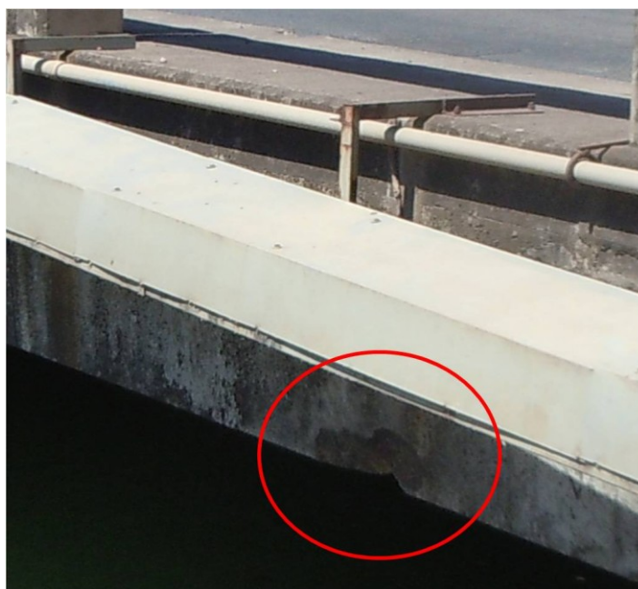
Figura 11: Desprendimiento de concreto en viga canal exterior (vista ampliada).
