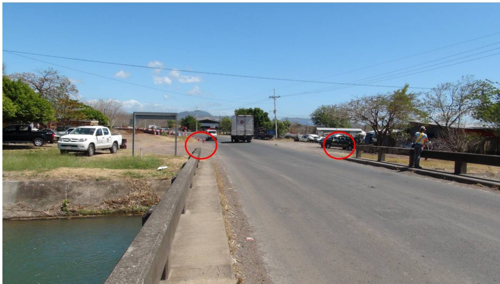
Figura 4: Ausencia de guardavías en los accesos al puente.
