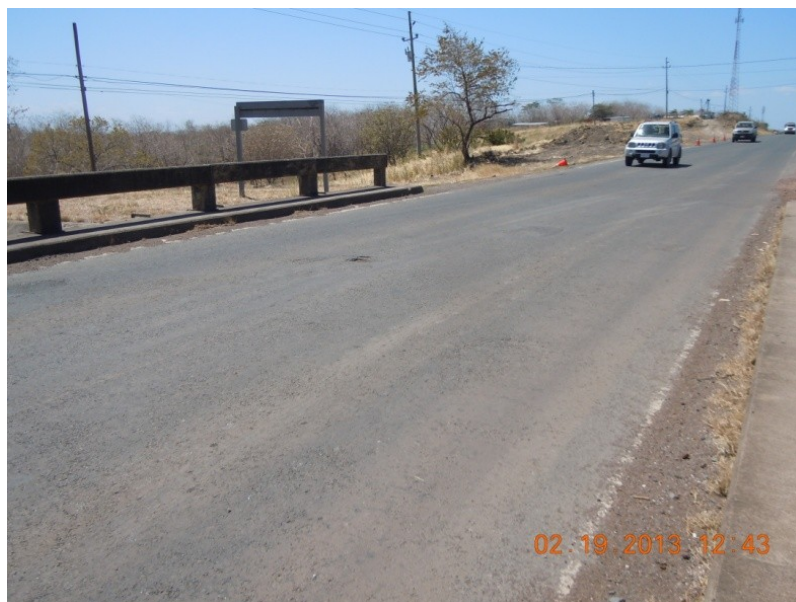
Figura 5: Demarcación vial inexistente, ausencia de captaluces, delineadores verticales e iluminación en el puente.
