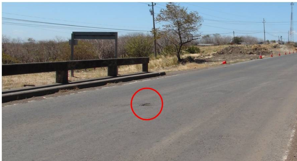
Figura 6: Bache en el pavimento.
