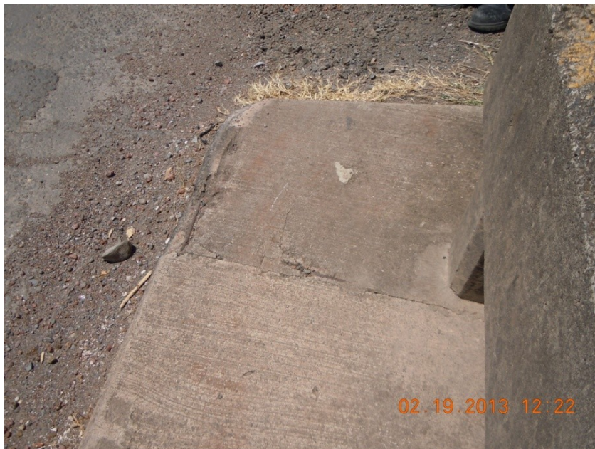
Figura 8: Acumulación de sedimentos y rocas a lo largo del bordillo
