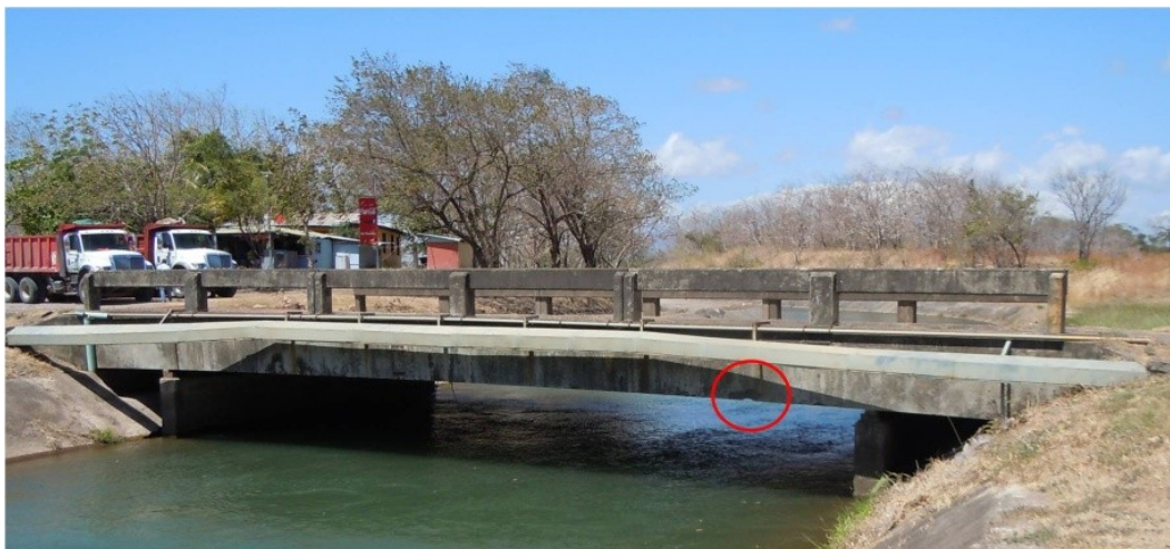
Figura 10: Vigueta exterior que presenta desprendimiento de concreto (vista panorámica).
