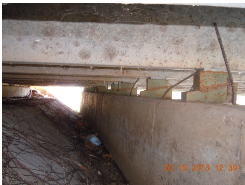
Figura 13: Oxidación y corrosión de los apoyos de las vigas interiores.
