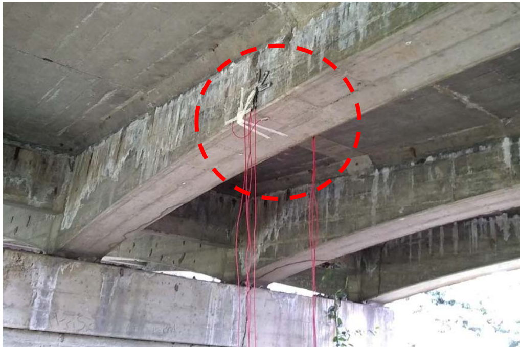
Figura 2. Sensores ya colocados en las vigas del puente sobre el río Jabilla.
