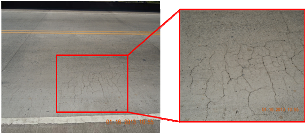
Figura 6. Agrietamiento en dos direcciones (con espesor mayor a 0,2mm) de sección de losa ubicada a 70m de la junta de expansión sobre el bastión este (Villalobos-Vega, et. al., 2013).
