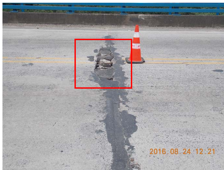
Figura 9. Huevo en el tablero de concreto con exposición del refuerzo.
