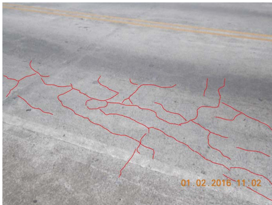
Figura 8. Agrietamiento en dos direcciones del tablero (01 de febrero del 2016).
