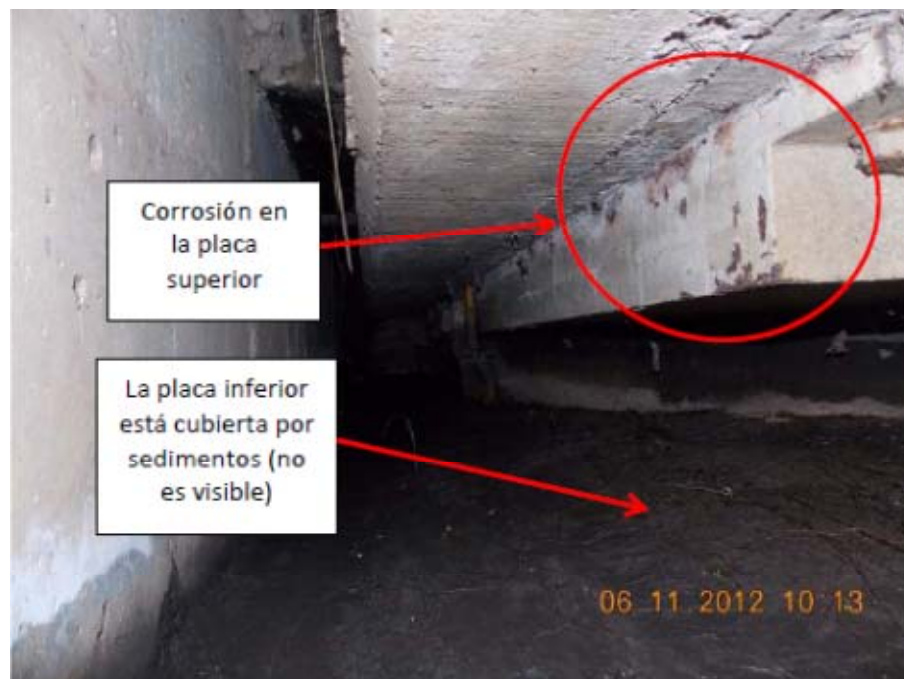
Figura 6. Apoyo norte del bastión este. Corrosión de la placa superior del apoyo. La placa inferior está cubierta con sedimentos (Agüero-Barrantes, et. al., 2013).
