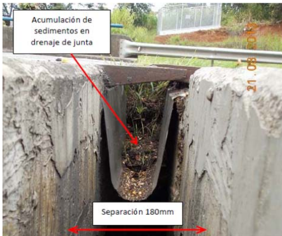
Figura 7. Drenaje obstruido con sedimentos y vegetación en junta del acceso oeste (Agüero-Barrantes, et. al., 2013).
