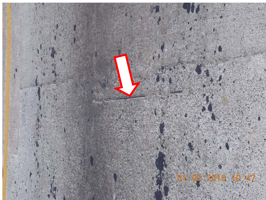
Figura 9. Desgaste de la superficie de rodamiento del tablero de concreto con exposición de barras de refuerzo (01 de febrero del 2016).
