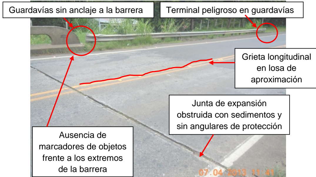
Figura 1: Acceso 1: Guardavías sin anclaje a la barrera y con terminales peligrosos (típico), junta de expansión obstruida con sedimentos y sin angulares de protección en el borde de la losa, grieta longitudinal en losa de aproximación y ausencia de marcadores de objetos.
