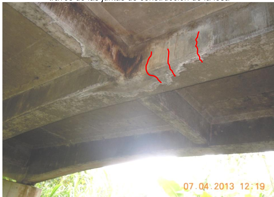
Figura 10: Grietas por flexión en el centro del tramo 1.
