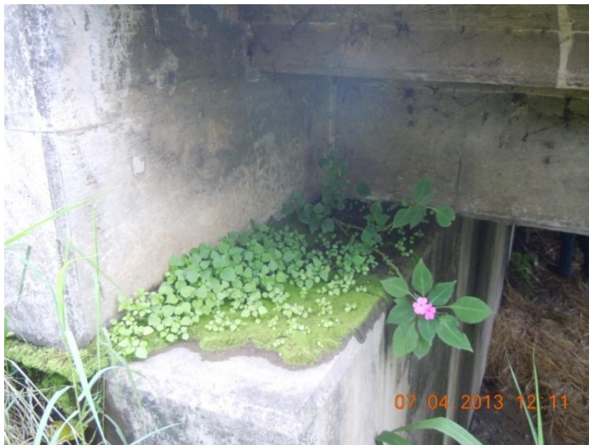
Figura 14: Crecimiento de maleza y ambiente húmedo sobre la viga cabezal del bastión 1, debido al ingreso de agua a través de las juntas por debajo de la viga diafragma.
