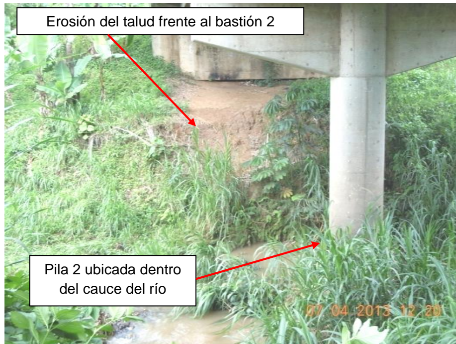
Figura 15: Erosión del talud frente al bastión 2 y pila 2 propensa a la socavación por estar dentro del cauce del río.
