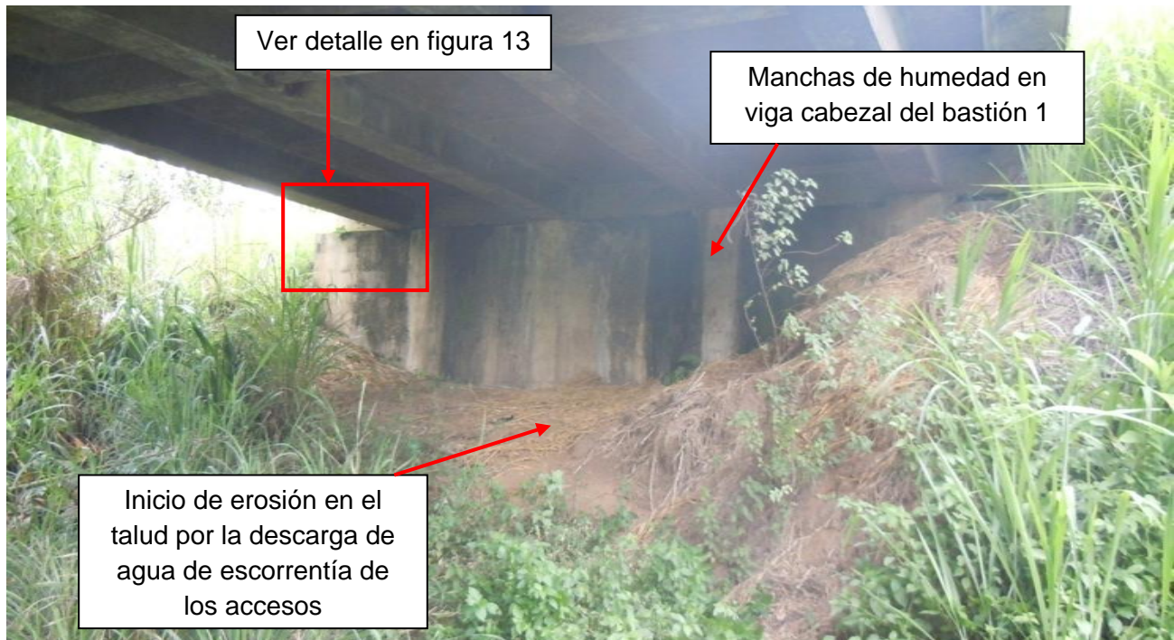
Figura 13: Manchas de humedad en viga cabezal del bastión 1 y erosión en el talud frente al bastión debido a la descarga de agua de escorrentía proveniente del acceso 1 del puente.
