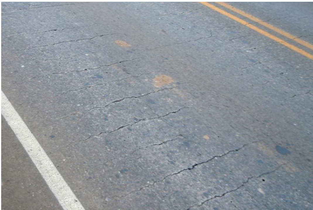
Figura 8: Detalle de grietas transversales y longitudinales en la losa
