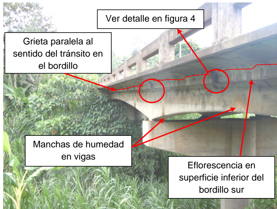
Figura 4: Ausencia de tubos de extensión en desagües del puente, eflorescencia y grieta paralela al sentido del tránsito en la superficie inferior del bordillo sur.
