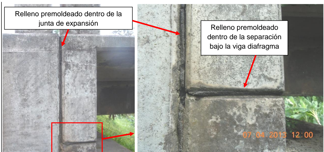
Figura 12: Detalles típicos de viga diafragma sobre ambos bastiones y ubicación del relleno premoldeado dentro de juntas de expansión y bajo vigas diafragma sobre los bastiones, a través del cual había ingreso de agua.
