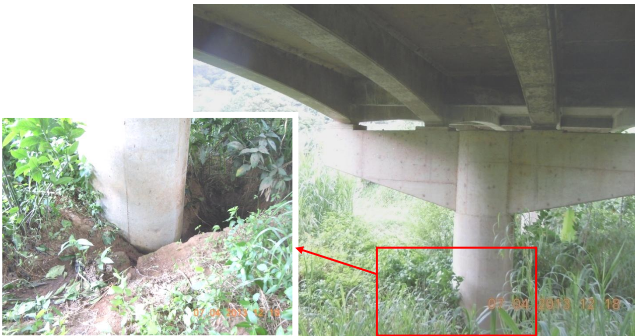
Figura 16: Inicio de socavación alrededor de la columna de la pila 1.
