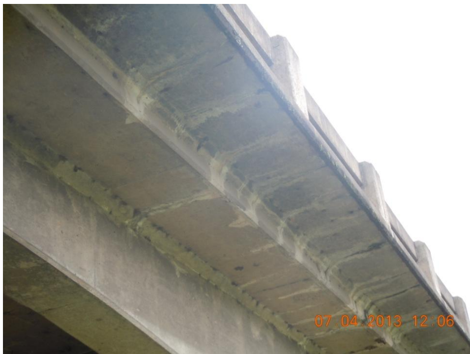
Figura 6: Grietas y eflorescencia en superficie inferior del bordillo norte.
