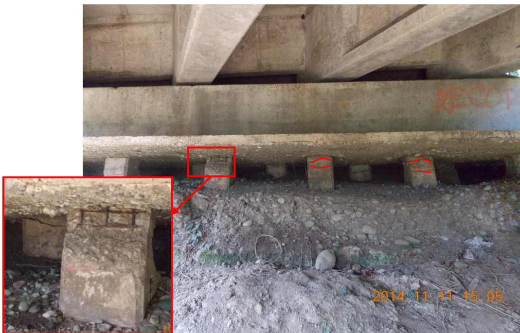
Figura 16: Pilotes expuestos y agrietados en bastión 2.
