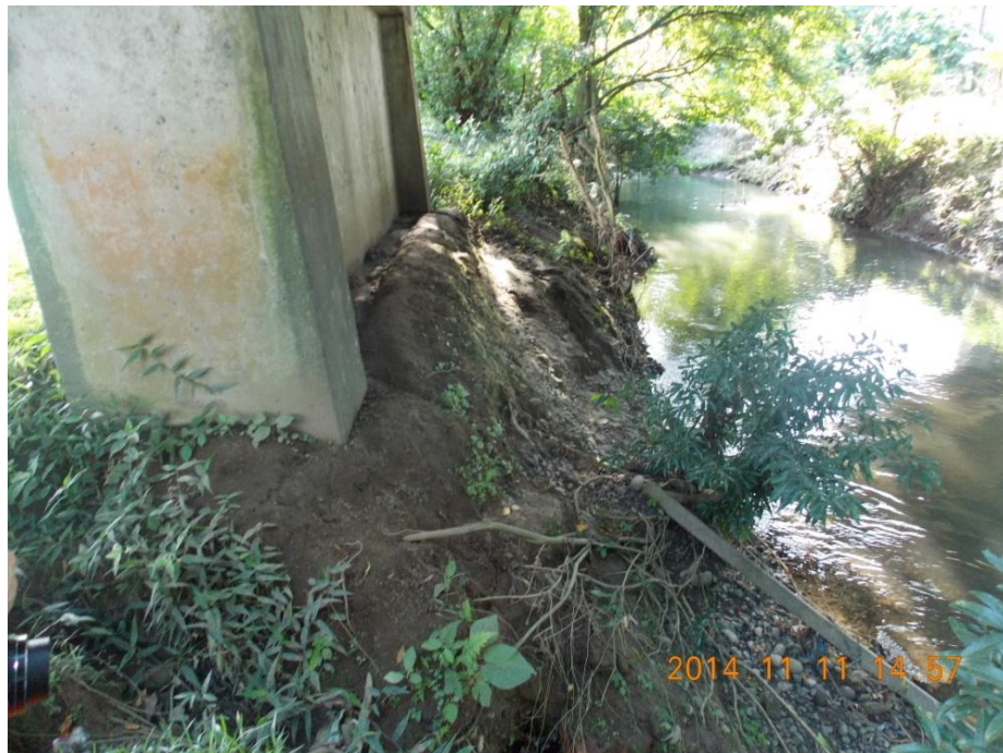
Figura 6: Erosión en el cauce del río contiguo a la pila 1 del puente.
