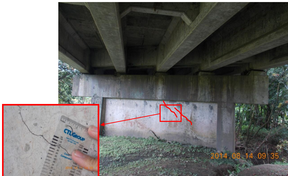
Figura 19: Grietas por cortante en muro pantalla de las pilas.
