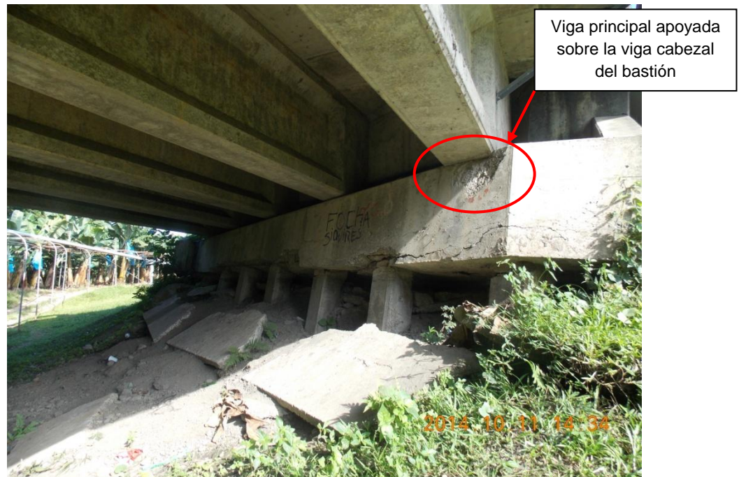
Figura 9: Vista del bastión 1 mostrando agrietamientos en la viga cabezal, exposición de pilotes y una viga principal apoyada directamente sobre la viga cabezal.
