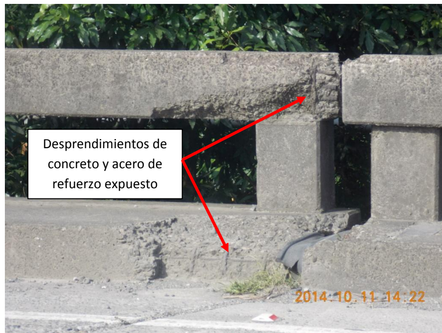
Figura 1: Daños en la barrera vehicular norte del puente, obstrucción del sistema de drenaje con sedimentos y maleza.
