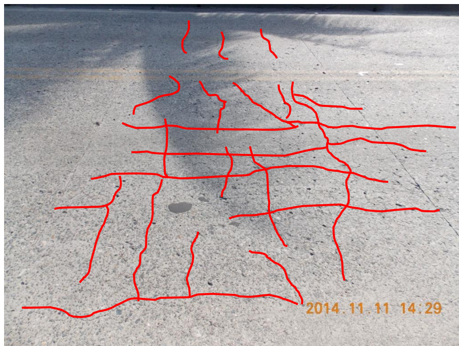
Figura 7: Agrietamiento típico en dos direcciones en la superficie superior de la losa de concreto del puente
