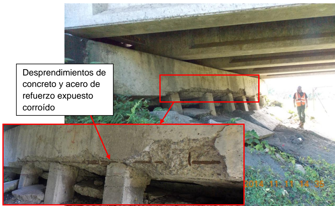
Figura 14: Rotación permanente del bastión 1, pilotes expuestos, desprendimientos de concreto y acero de refuerzo expuesto y corroído.
