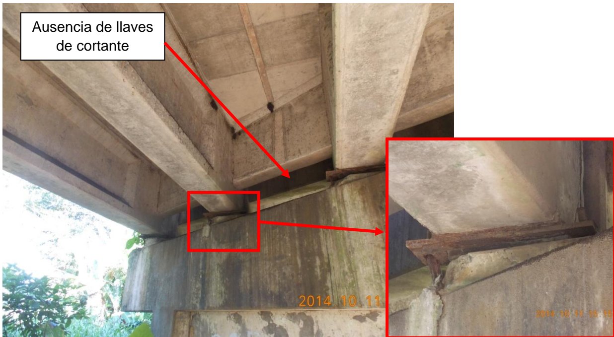
Figura 13: Desprendimientos de concreto en pedestales de los apoyos sobre la pila 2 que ha reducido la longitud de asiento y corrosión de elementos metálicos.
