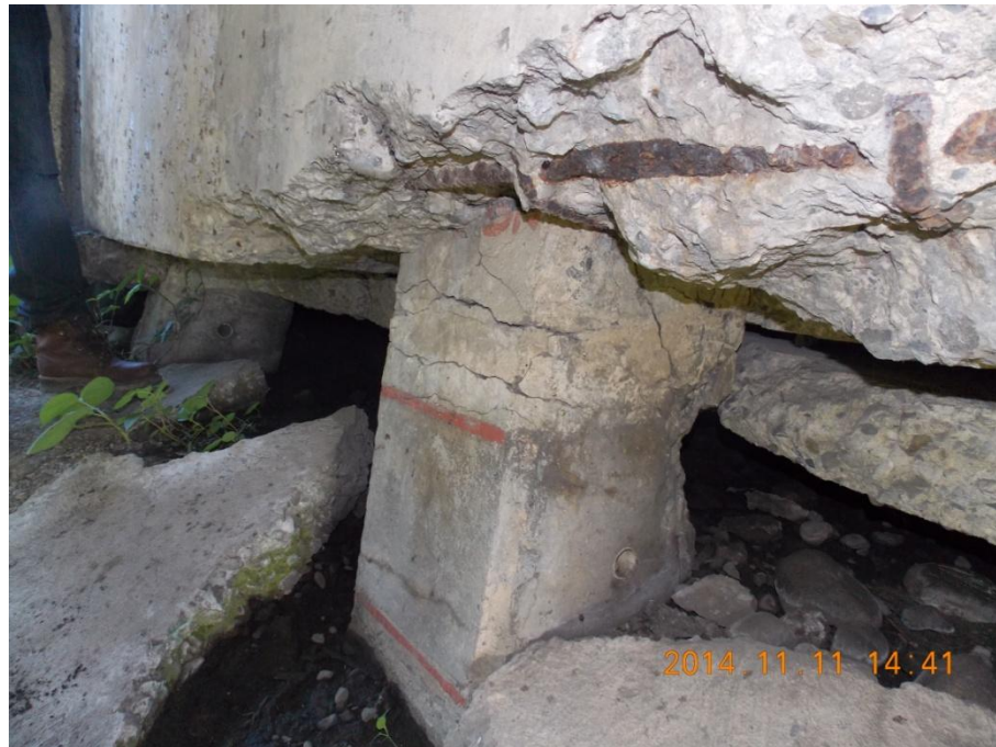
Figura 15: Agrietamiento típico en pilotes, desprendimientos de concreto y acero de refuerzo expuesto y corroído (vista del bastión 1).
