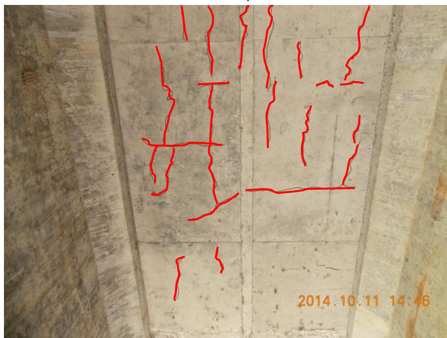
Figura 8: Agrietamiento típico en la superficie inferior de la losa del puente (grietas resaltadas).
