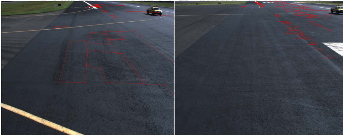
Figura A. 2 Desprendimiento de agregado. Carril 1
