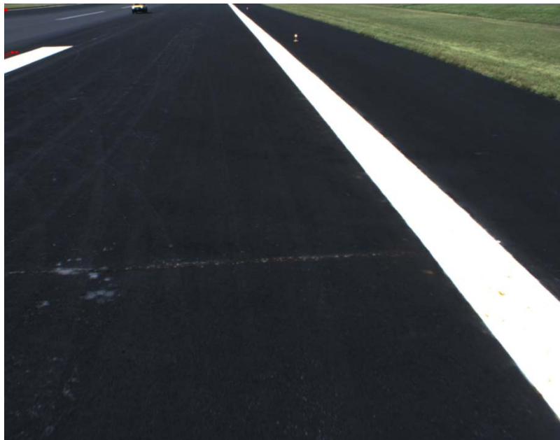
Figura A. 5 Grieta Transversal. Carril 2
