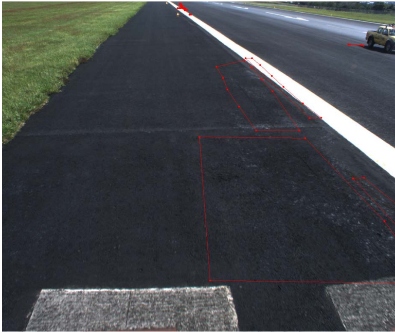
Figura A. 1 Grieta longitudinal y desprendimiento de agregado. Carril 1
