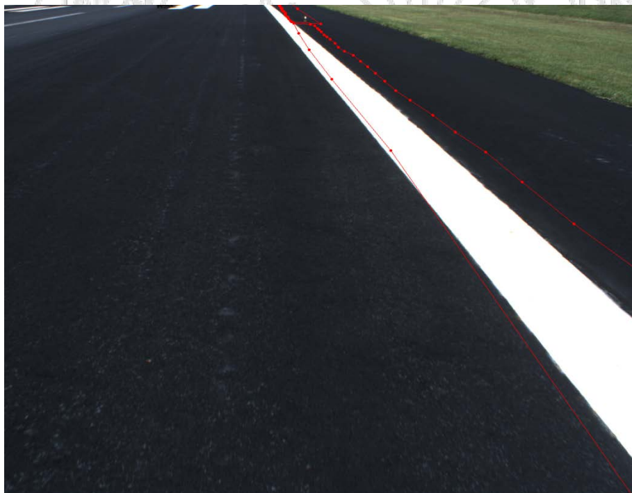
Figura A. 6 Desprendimiento de agregado. Carril 2
