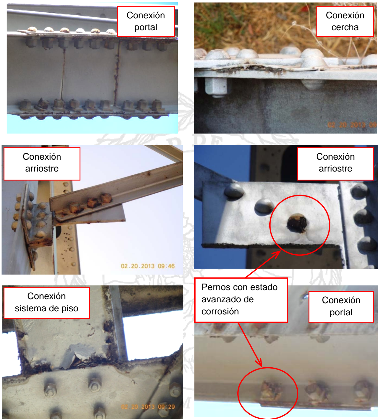
Figura 21: Corrosión en las conexiones de la cercha, sistema de piso, portales y sistema de arriostamiento
