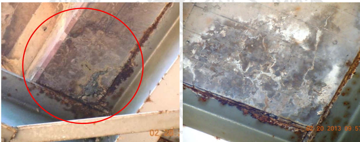
Figura 16: Manchas de humedad en los extremos de la sección transversal de la losa de concreto.
