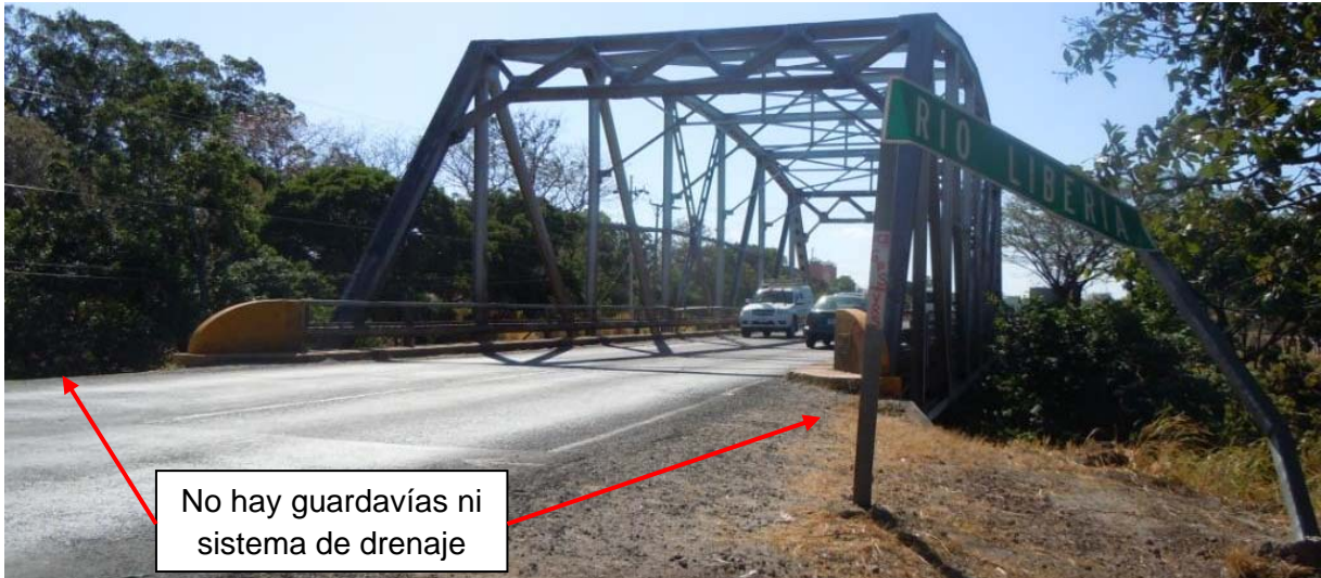
Figura 7: Faltante de guardavías y sistema de drenaje en ambos accesos, caso del acceso norte.
