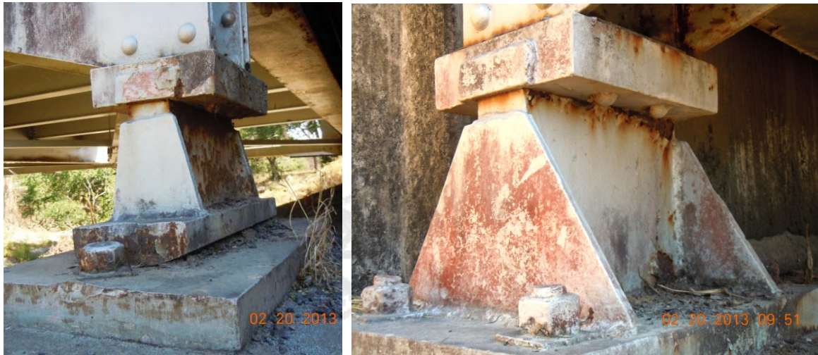
Figura 22: Oxidación y principios de corrosión en los apoyos.
