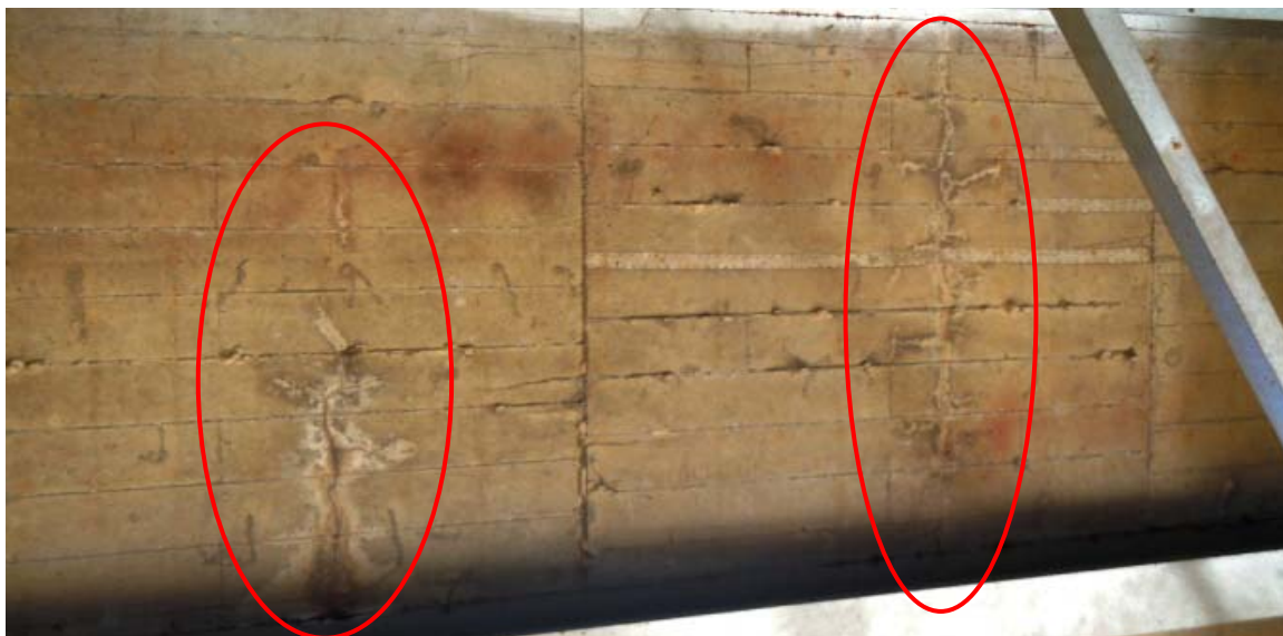
Figura 15: Agrietamiento transversal en la losa de concreto con evidencia de eflorescencia.
