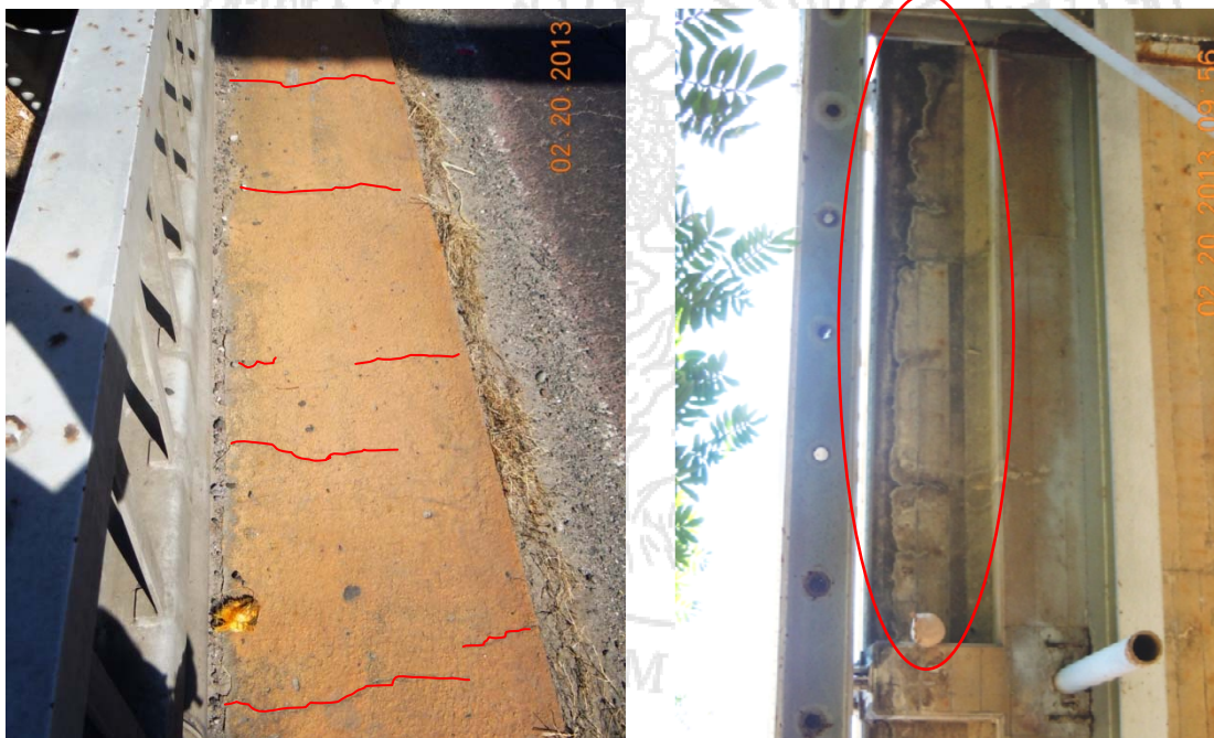
Figura 8: Agrietamiento transversal del bordillo de seguridad, sector oeste.
