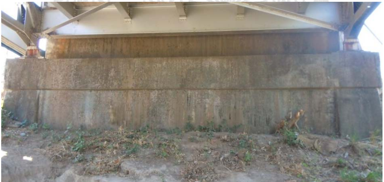
Figura 23: Filtración de agua a través de las juntas de expansión de ambos bastiones.
