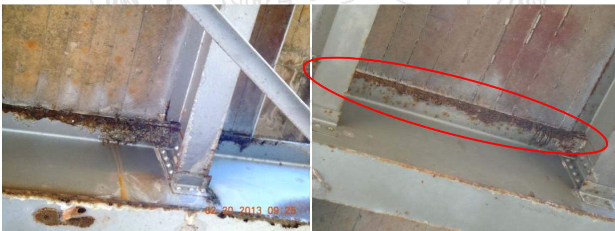
Figura 20: Corrosión avanzada en algunas vigas transversales.
