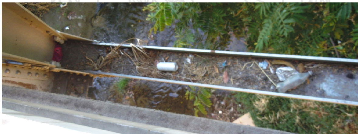
Figura 18: Acumulación de sedimentos, vegetación y basura en la cuerda inferior de la cercha.
