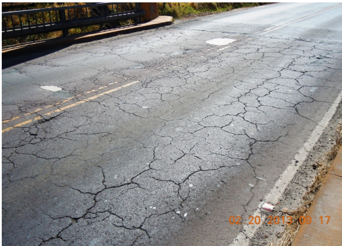
Figura 9: Demarcación horizontal mala, pérdida parcial de los captaluces de la línea centro y agrietamiento en red en la superficie de rodamiento.
