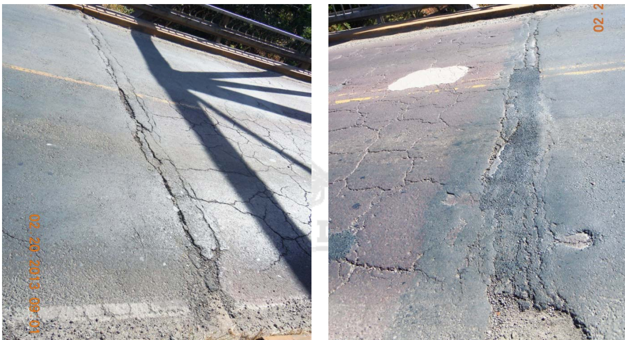
Figura 13: Obstrucción de las juntas de expansión de ambos accesos.
