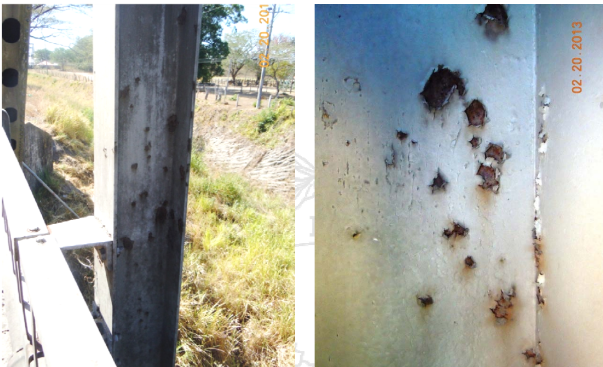
Figura 17: Zonas puntuales de corrosión en los elementos de la armadura. Izquierda: vertical. Derecha: interior de la sección armada de la cuerda superior.
