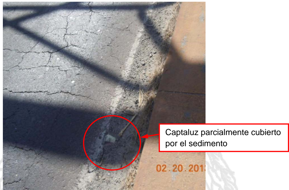
Figura 11: Acumulación de sedimentos y maleza en los bordillos de seguridad, así como captaluzes parcial o totalmente cubiertos.
