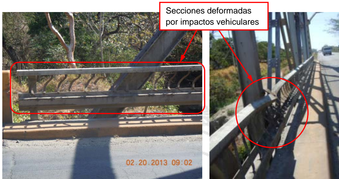
Figura 5: Barrera de acero diseñada de acuerdo con AASHO 1949 que no cumple con los requerimientos de una tipo TL-4 según AASHTO LRFD 2012 y secciones deformadas por impactos vehiculares en barrera del sector este.
