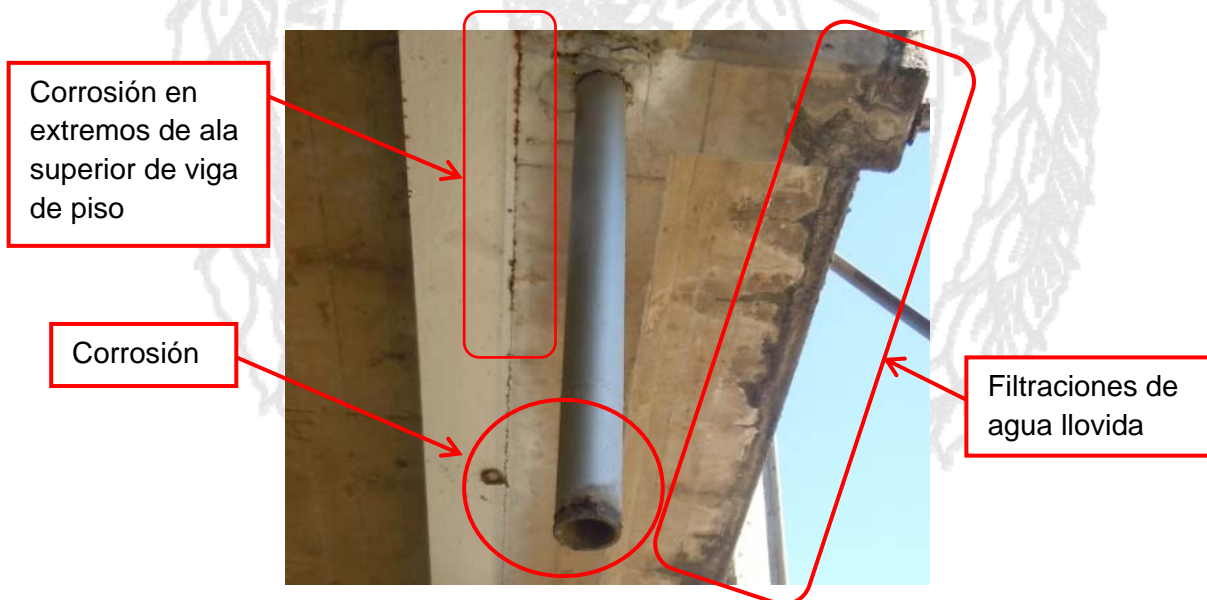
Figura 12: Tubos de extensión de los drenajes con signos de oxidación en el extremo, flujo de agua llovida por el voladizo lateral de la losa y corrosión en ala superior de viga de piso. .
