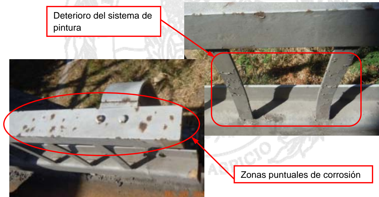
Figura 6: Deterioro del sistema de pintura así como zonas puntuales de corrosión a todo lo largo de la barrera vehicular.
