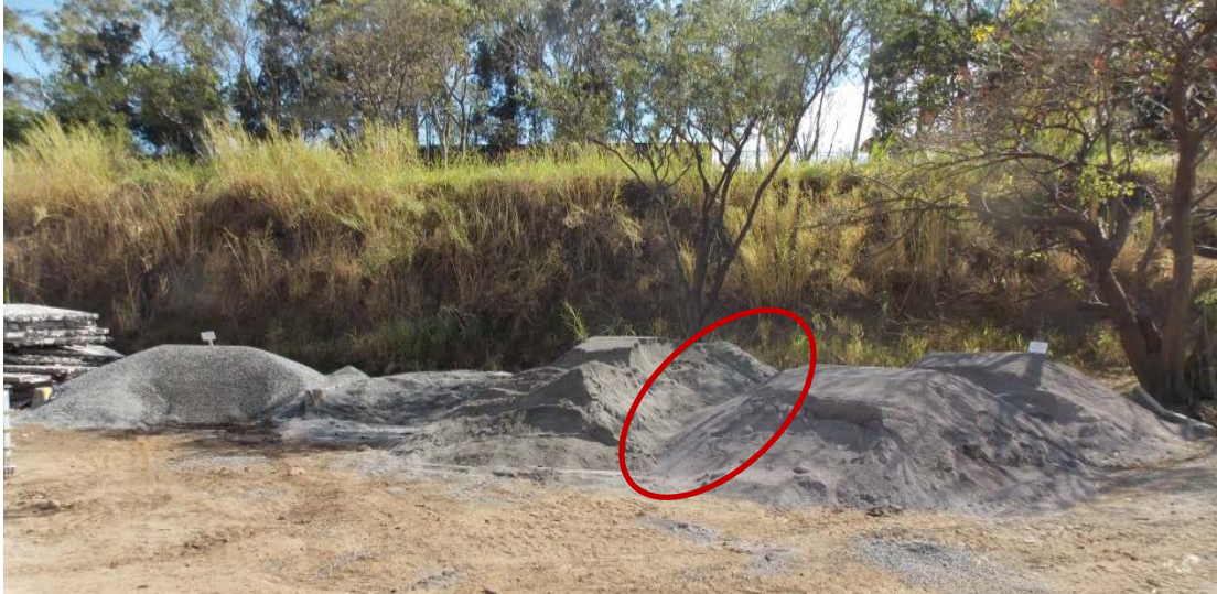
Fotografía 2. Apilamiento incorrecto de agregados. Fecha: 10/02/17. Fuente: Unidad de Auditoría Técnica.
