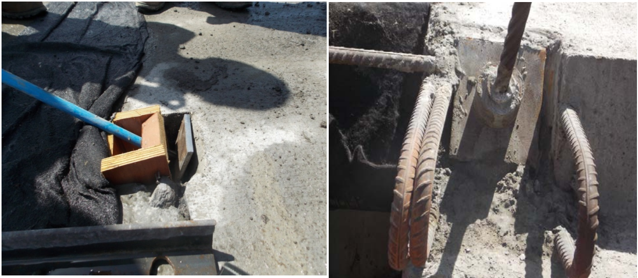
Fotografía 4. Recubrimiento deficiente de los elementos de acero. Fecha: 10/02/17. Fuente: Unidad de Auditoría Técnica.
