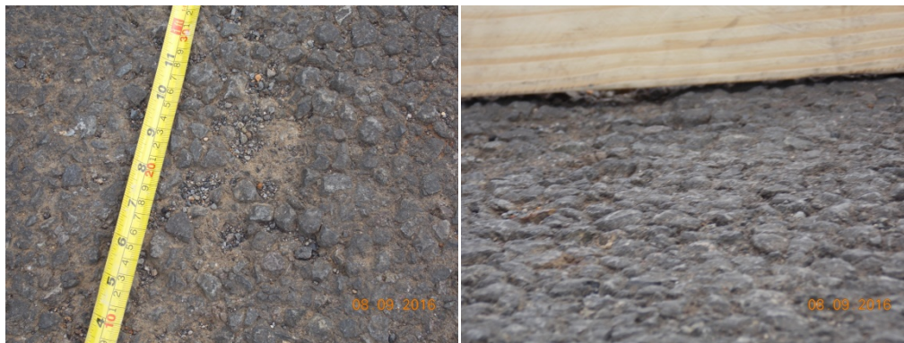
Figura 7 y Figura 8. Deterioro de la carpeta y huecos. Estacionamiento 10+600. Fecha de las fotografías 08/09/2016. Fuente: LanammeUCR.
