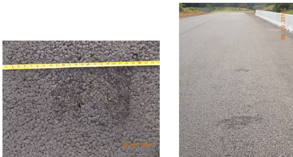
Figura 9 y Figura 10. Deterioro de la carpeta y huecos. Estacionamiento 4+200. Fecha de las fotografías 08/09/2016. Fuente: LanammeUCR.
