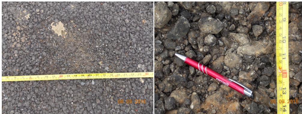
Figura 11 y Figura 12. Desprendimiento de agregado y huecos. Estacionamiento 25+400. Fecha de las fotografías 08/09/2016. Fuente: LanammeUCR.
