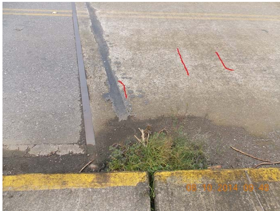
Figura 6: Agrietamiento en la cara superior del tablero.
