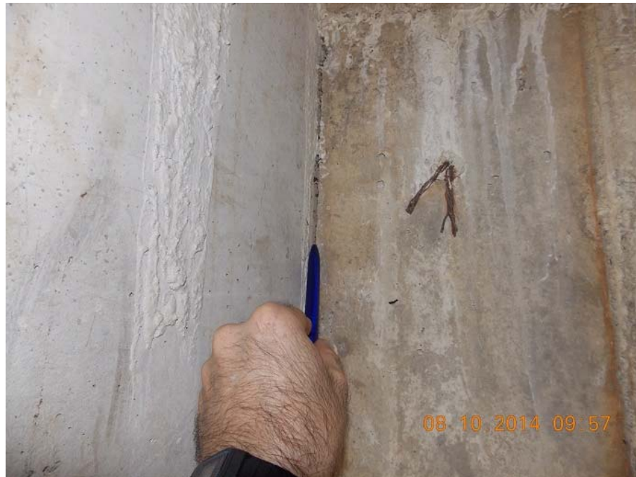
Figura 9: Separación entre la viga diafragma y la viga principal.
