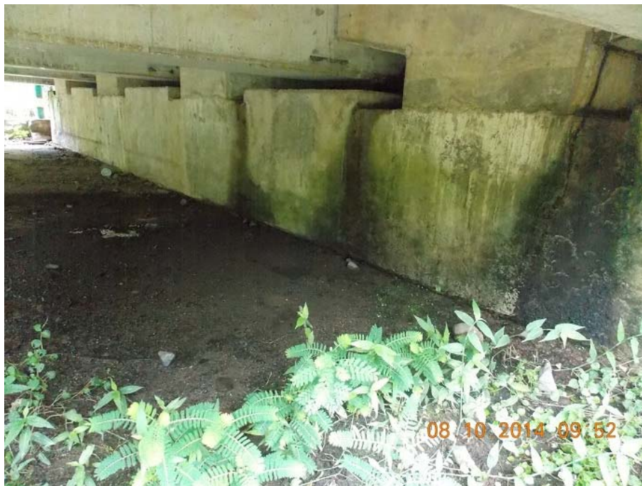
Figura 12: Evidencia de filtraciones sobre los bastiones.
