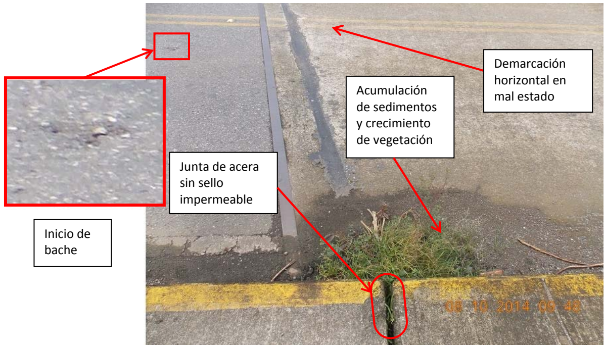
Figura 5: Acumulación de sedimentos, ausencia de sello, inicio de baches y demarcación.
