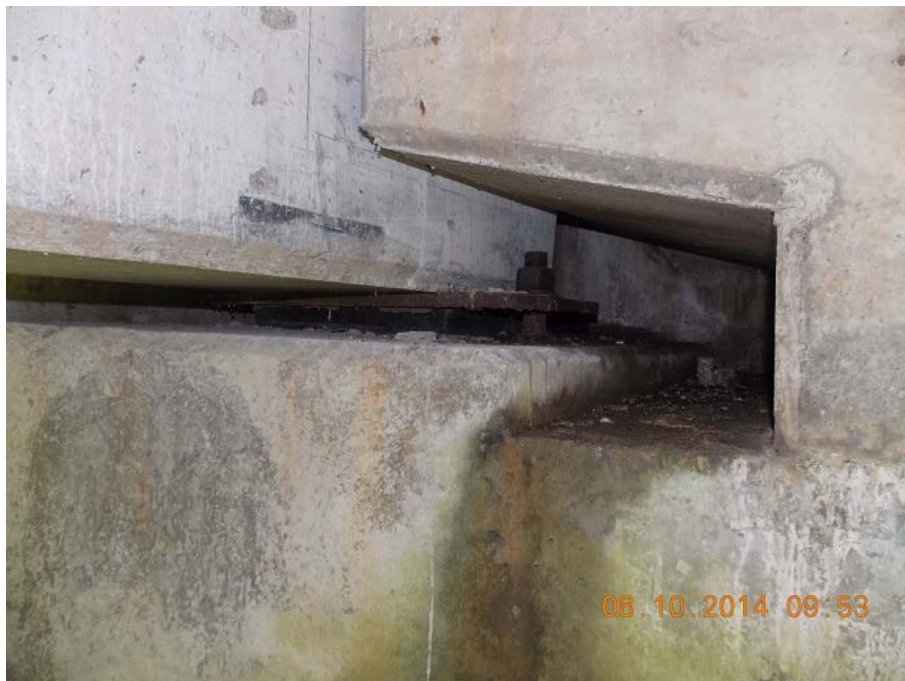
Figura 11: Apoyo en contacto con sedimentos y elementos metálicos oxidados.
