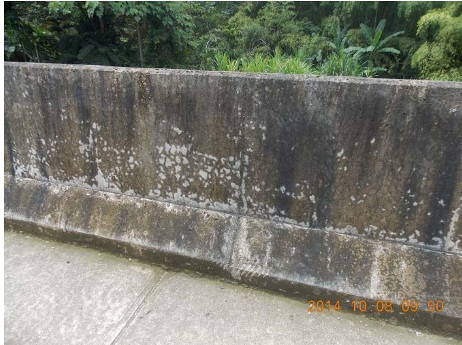
Figura 1: Barrera vehicular cubierta con moho.
