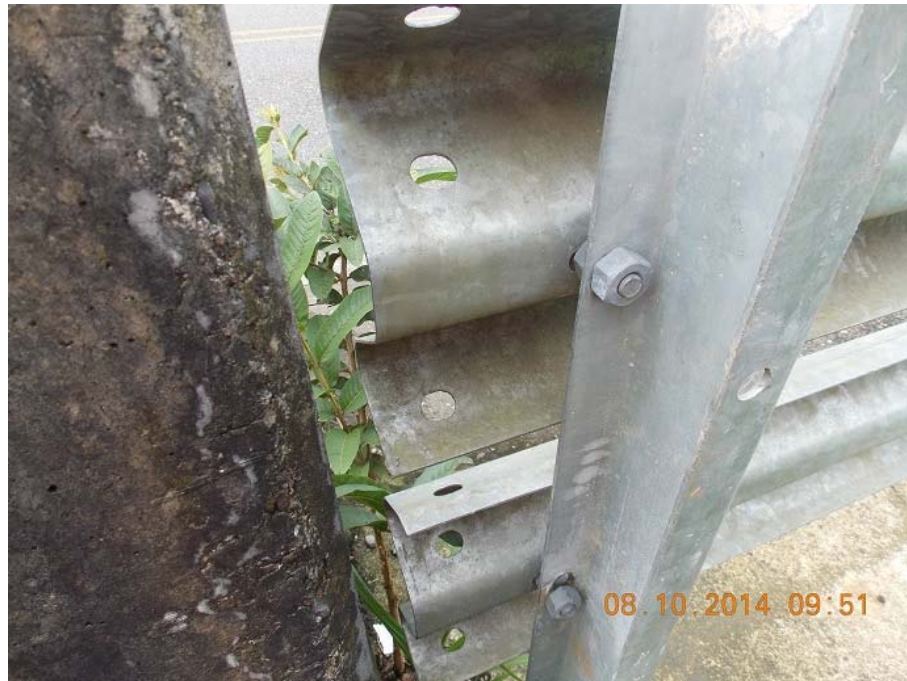
Figura 3: Guardavías no conectado a la barrera vehicular.
