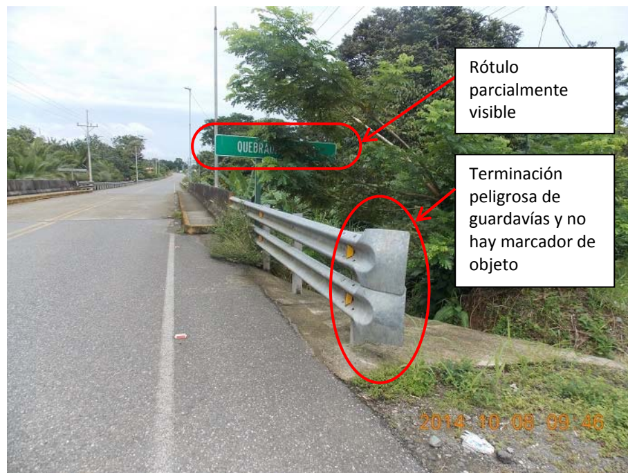
Figura 2: Guardavías con terminación peligrosa y rotulación parcialmente visible.
