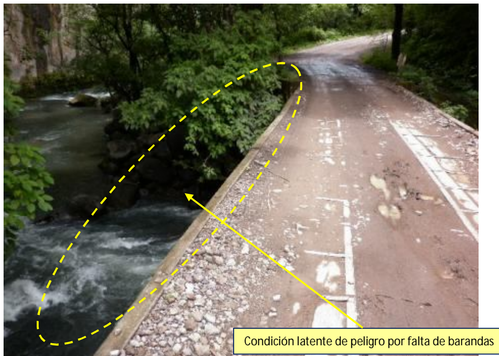
Figura 5. Inexistencia de barandas en el puente
