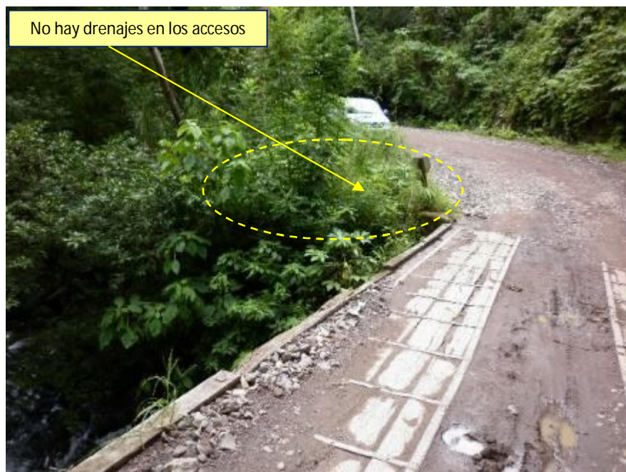
Figura 9. Accesos del puente presentan ausencia de drenajes laterales
