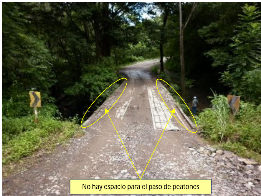
Figura 6. El puente no tiene aceras en sus costados
