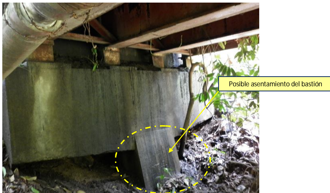
Figura 15. Estado de los bastiones
