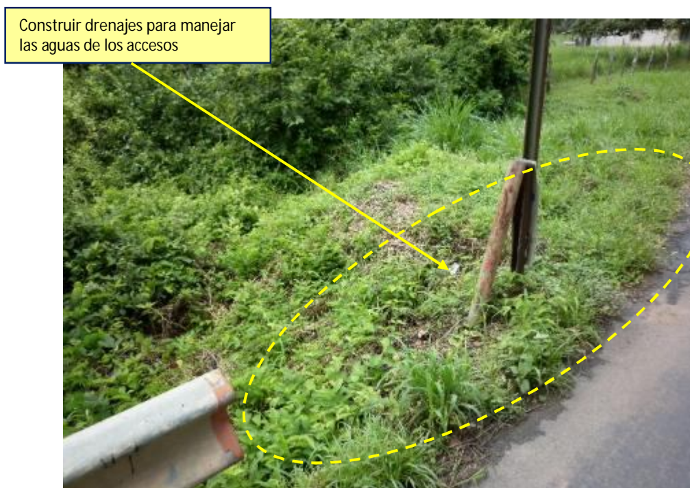
Figura 9. Accesos del puente presentan ausencia de drenajes laterales
