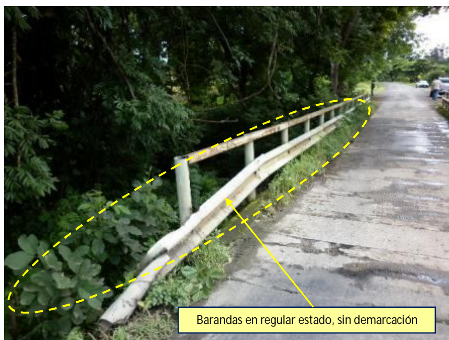
Figura 5. Barandas sin pintura reflectiva
