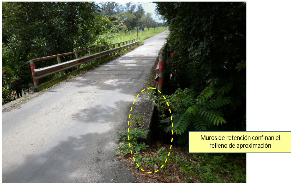
Figura 16. No hay aletones en los rellenos de aproximación
