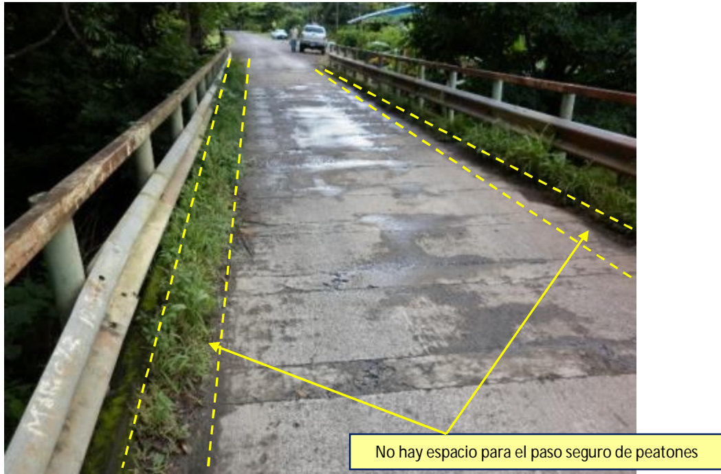
Figura 6. El puente no tiene aceras en sus costados
