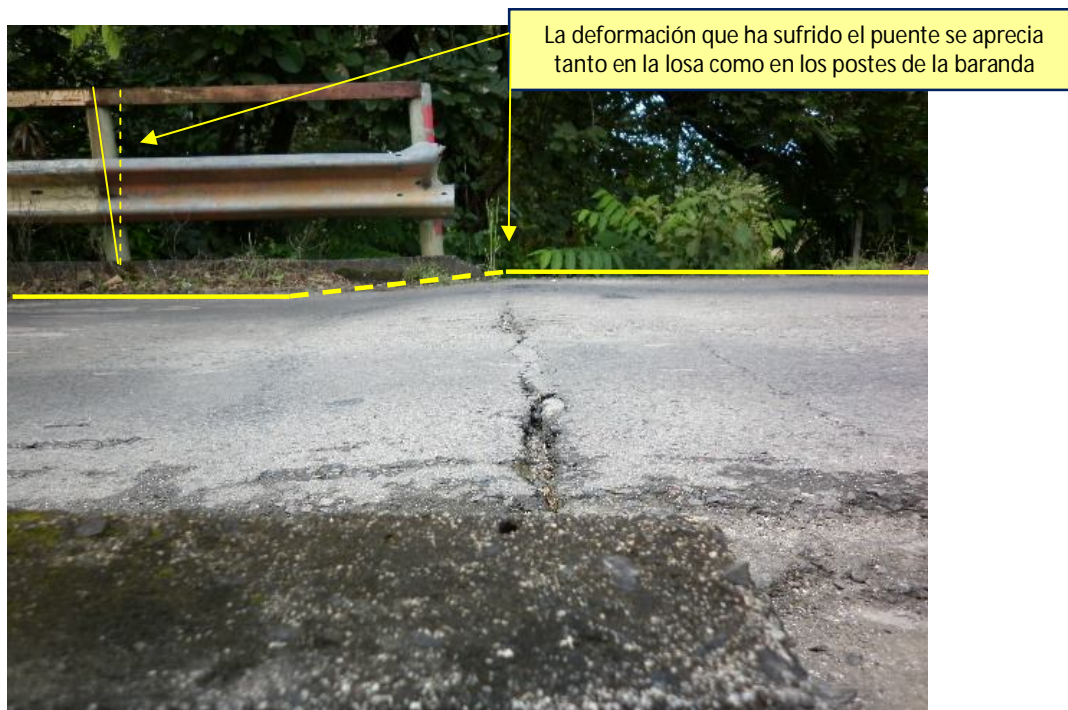
Figura 14. Evidente desnivel de los accesos y la losa causado por problemas en el bastión y apoyo
