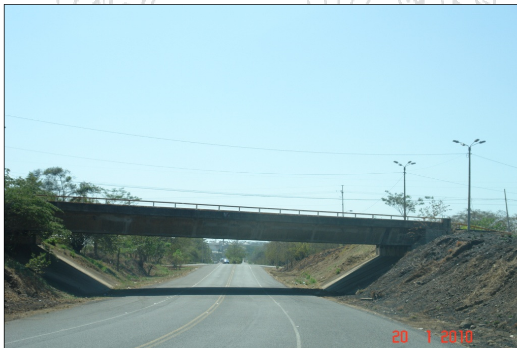
Fotografía 5. Paso Superior Sobre Ruta 23. Estado del paso superior al 20 de enero de 2010. (LanammeUCR, 2009).
