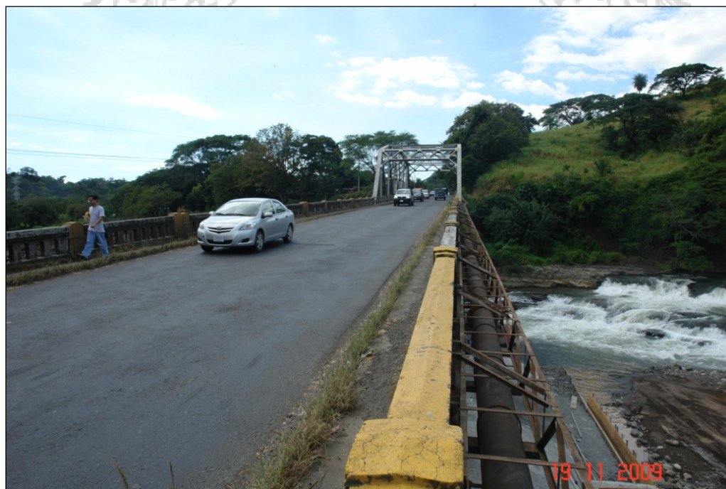
Fotografía 3. Puente sobre el Río Barranca. Estado del puente al 19 de noviembre de 2009. (LanammeUCR, 2009).
