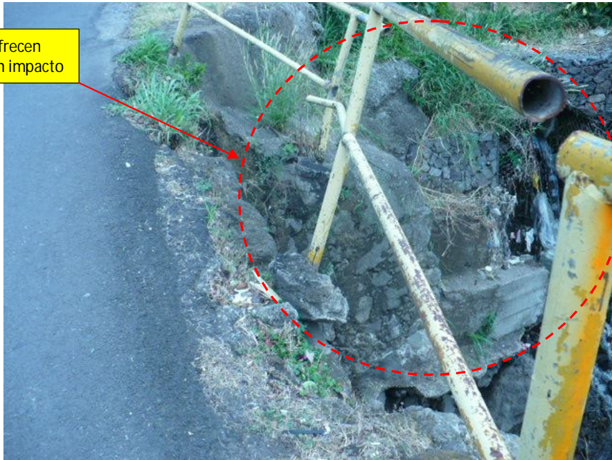
Figura 6. Barandas de acero en mal estado
