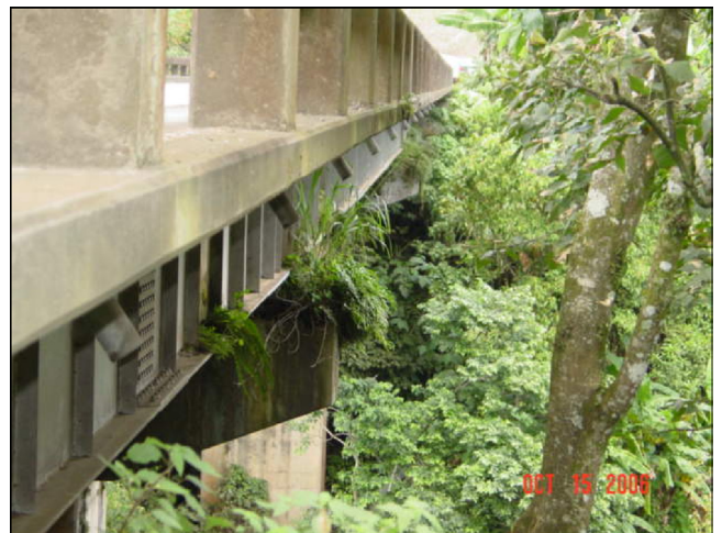
Estado de las vigas
