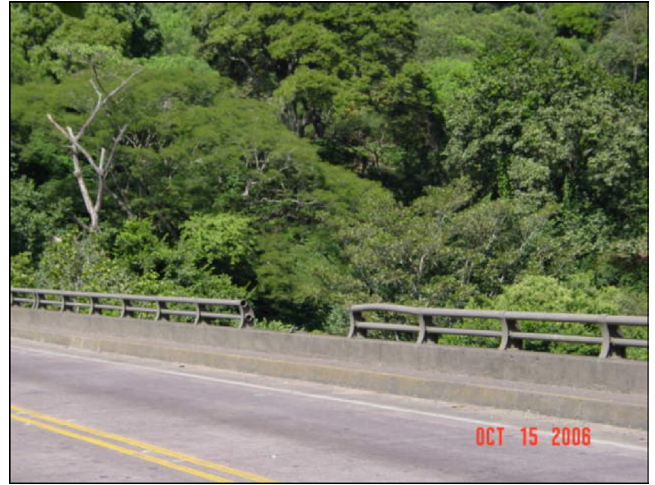
Estado de la baranda
