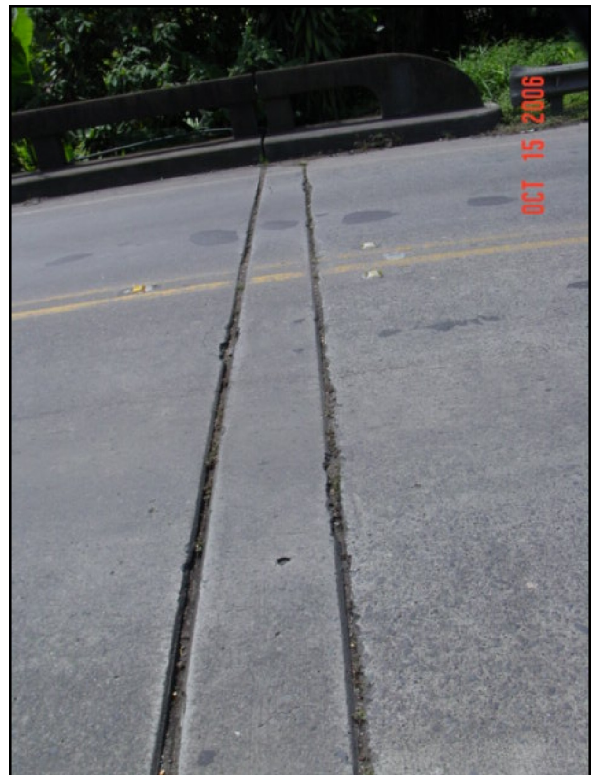
Grieta en losa superior
