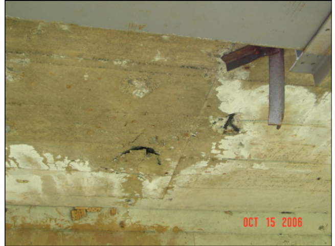
Estado de la losa
