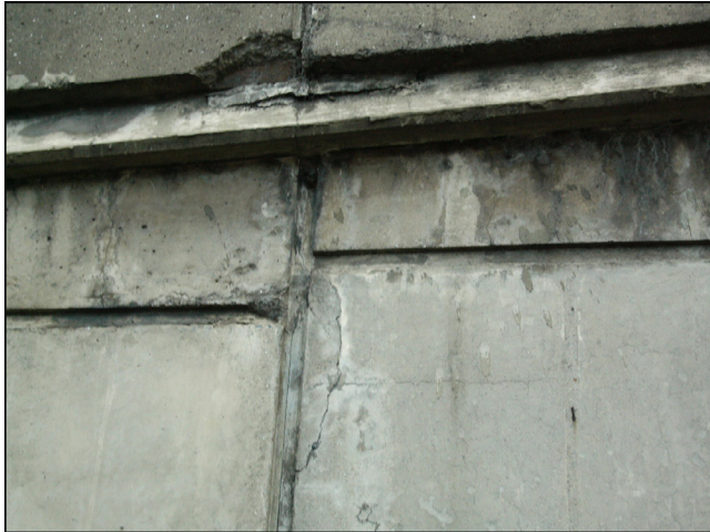
Fisura en bastión
