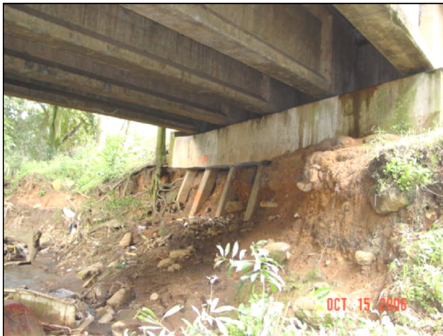
Socavación en bastión
