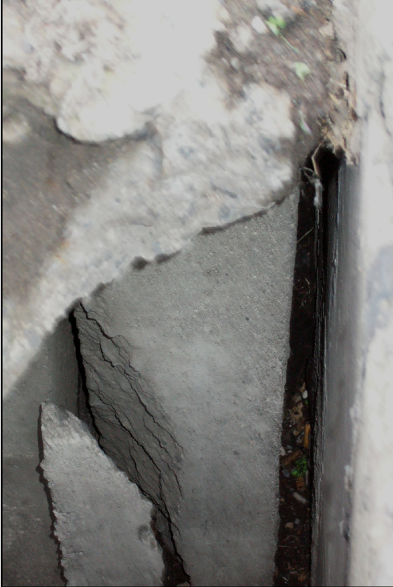
Grieta en Diafragma
