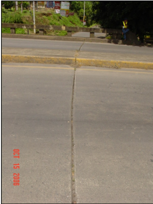
Grieta en losa superior
