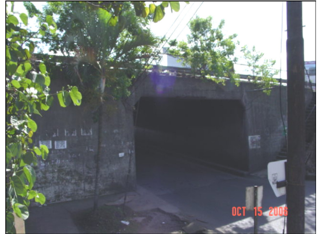
Estado de losa superior e inferior
