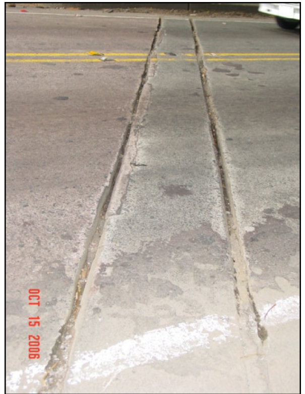
Grieta en losa superior
