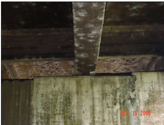
Estado de las vigas
