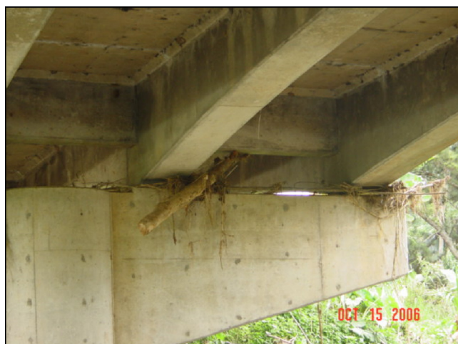
Estado de suciedad en la pila
