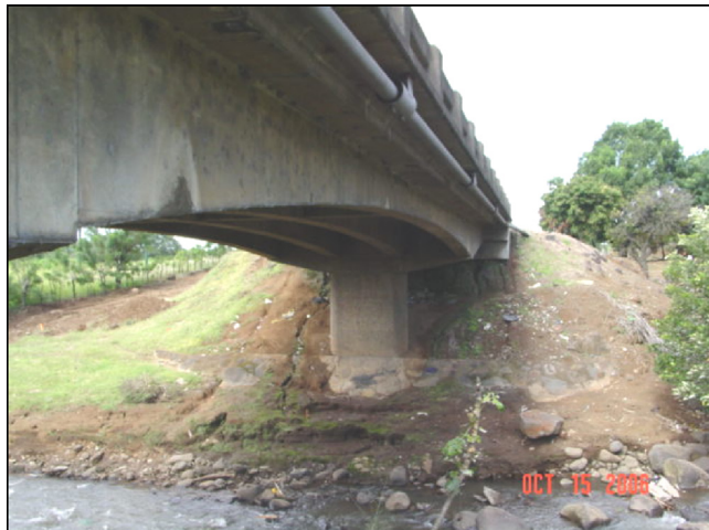
Grieta en viga
