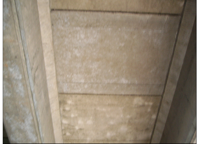
Estado de las losetas
