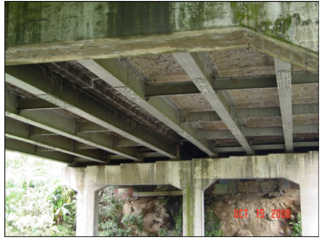
Estado de las vigas
