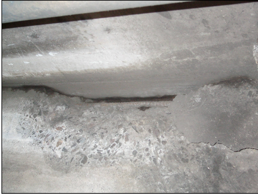
Pérdida de concreto en bastión
