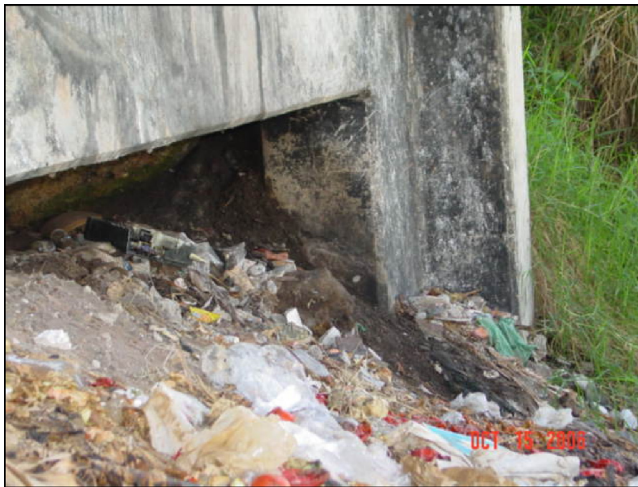
Condición de suciedad en el bastión
