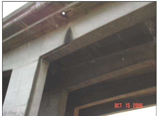
Mancha por flujo de agua en pila
