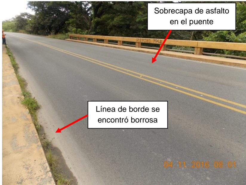
Figura 4. Demarcación horizontal en el puente con líneas de centro en buen estado y líneas de borde en mal estado. Sobrecapa de asfalto sobre el puente.
