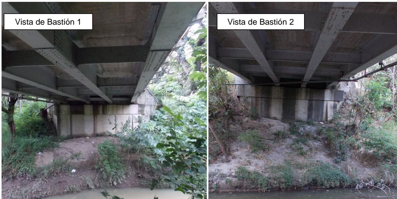
Figura 12. Talud frente a los bastiones sin protección y manchas de humedad en la viga cabezal de ambos bastiones.
