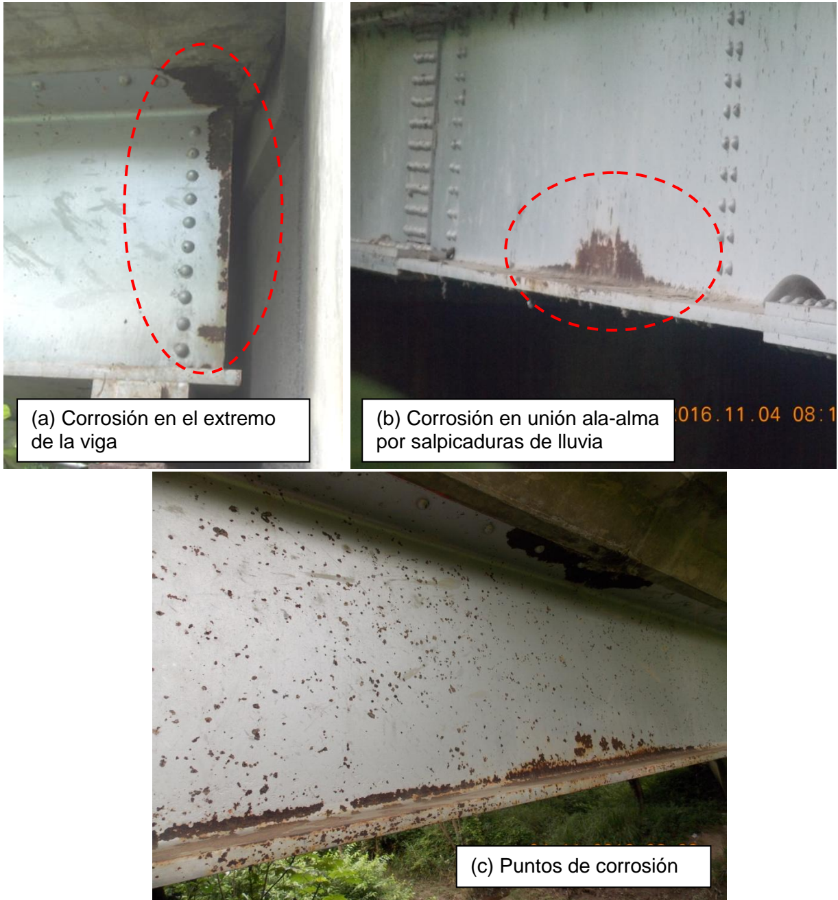
Figura 10. Zonas con corrosión localizada y puntos de corrosión en las vigas principales.
