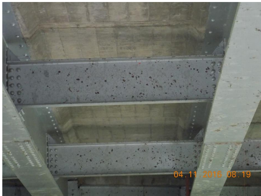
Figura 9. Puntos de corrosión en las vigas diafragma de acero.
