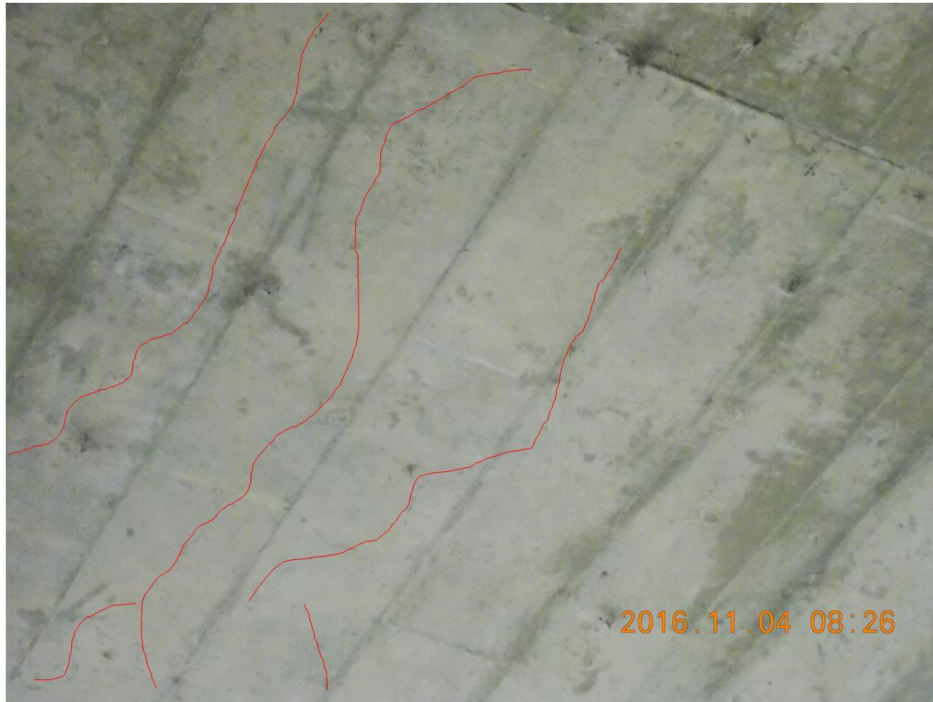
Figura 8. Grietas en una dirección en la superficie inferior de la losa.
