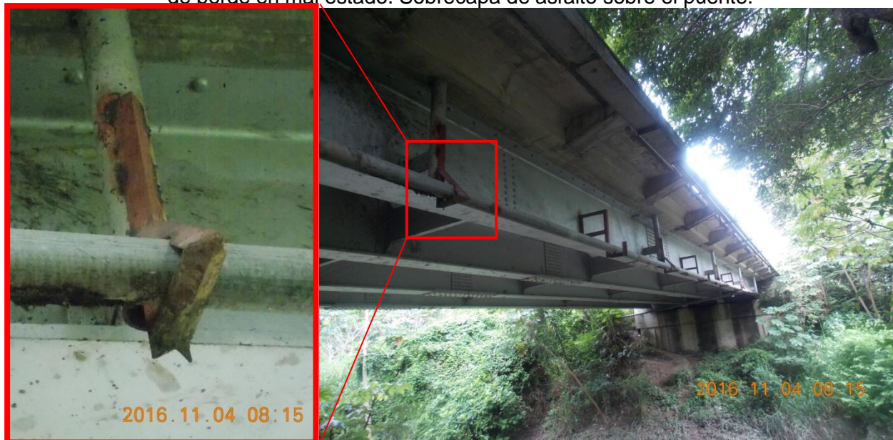
Figura 5. Tubería de servicio soldada a ductos de salida del sistema de drenaje del puente. Esta tubería se encuentra corroída en los puntos de salida del sistema de drenaje.
