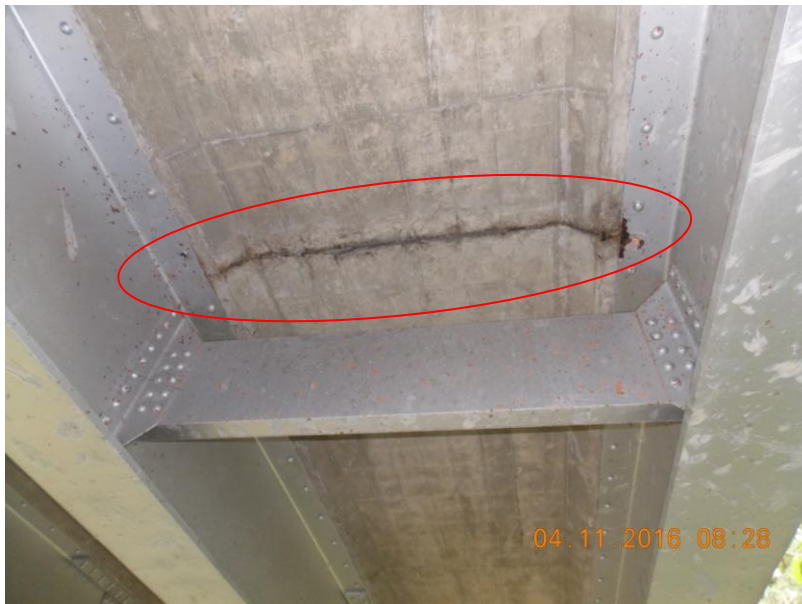
Figura 7. Grieta a lo largo de la junta de construcción de la losa de concreto con mancha de humedad.
