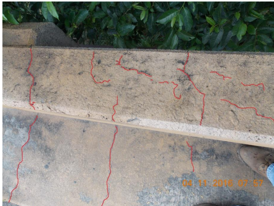
Figura 1. Agrietamiento de la barrera vehicular y el bordillo de seguridad.
