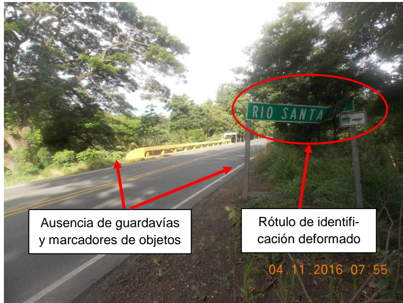
Figura 2. Ausencia de guardavías y marcadores de objetos y rótulo de identificación deformado
