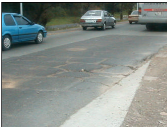
Fotografía 1 Calzada con deterioro severo
