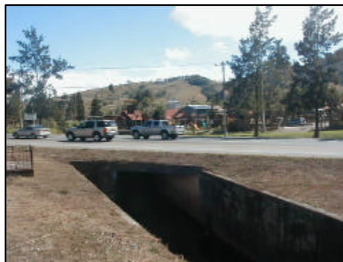
Fotografía 43 Alcantarilla profunda sin protección lazos de giro en “U” bomba Cristo Rey
