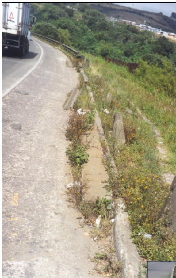
Fotografía 19 Sistema de contención deteriorado en curva peligrosa
