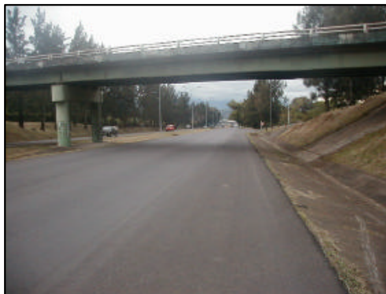
Fotografía 4 Espaldón no demarcado en sección de intercambio, inexistencia total de demarcación horizontal
