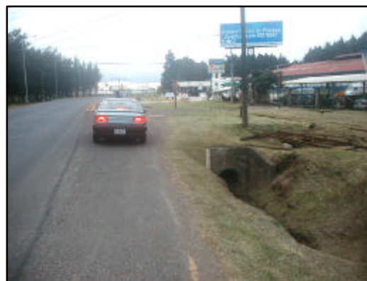
Fotografía 17 Cuneta profunda sin protección
