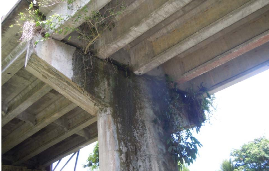
Figura 15. Manchas de humedad que evidencian filtración de agua en junta de expansión ubicada en pila 1 (P1) así como crecimiento de vegetación en la zona de los apoyos.
