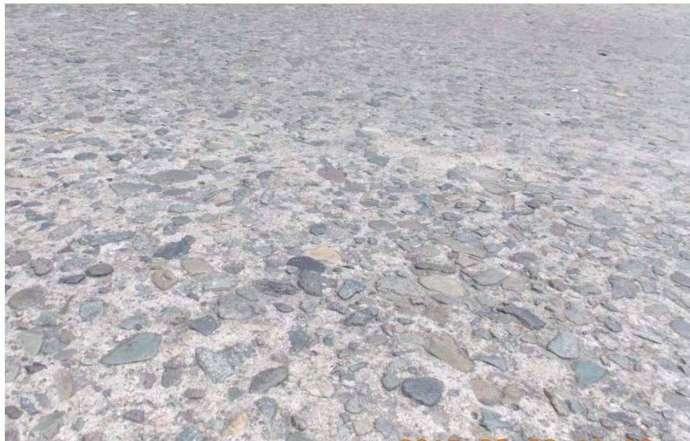
Figura 8. Desgaste superficial de losa de concreto.
