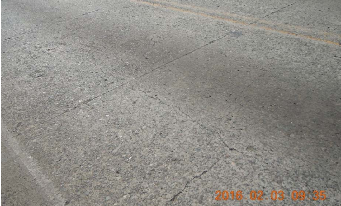
Figura 7. Agrietamiento en ambas direcciones con un ancho de grieta mayor a 0,2mm y con intervalos menores a 50cm observado en la superficie superior de la losa de concreto. Caso de la superestructura 3.
