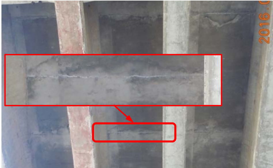
Figura 9. Evidencia de eflorescencia en juntas de construcción. Caso de superestructura 2..
