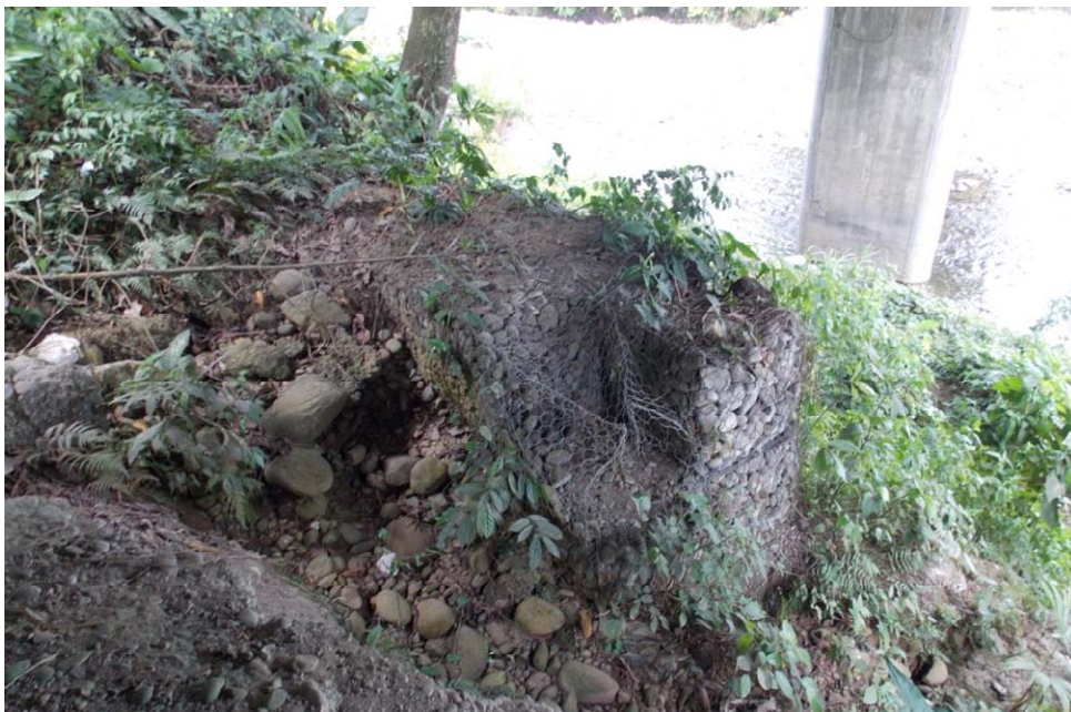
Figura 16. Deterioro del muro de gaviones ubicado aguas arriba del talud frente al bastión 2 (B2).
