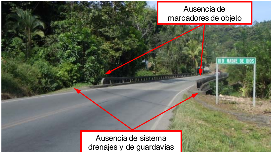
Figura 1. Ausencia marcadores de objeto, sistema de drenajes y guardavías en ambos accesos. Caso del acceso 2.
