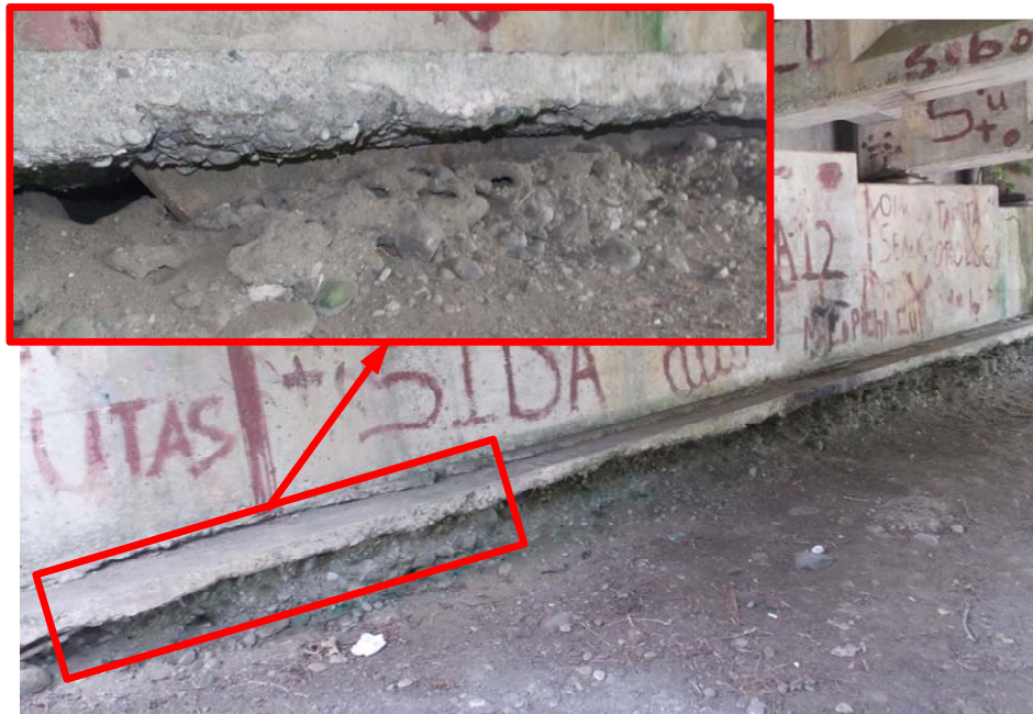
Figura 14. Socavación de la viga cabezal del bastión 1 (B1).
