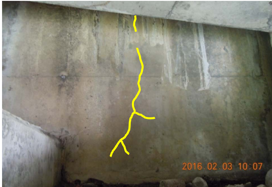
Figura 13. Agrietamiento vertical en la pared del cabezal del bastion B1, con un espesor de 0,35mm.
