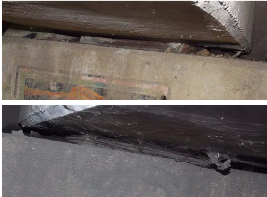
Figura 12. Deformación lateral, abultamiento y agrietamiento superficial en almohadillas de neopreno del bastión 1.
