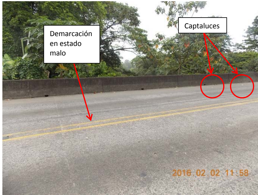
Figura 3. Demarcación horizontal en mal estado y ausencia de captaluces aguas abajo (se indica donde se ubican los captaluces en el tramo que abarca la fotografía).
