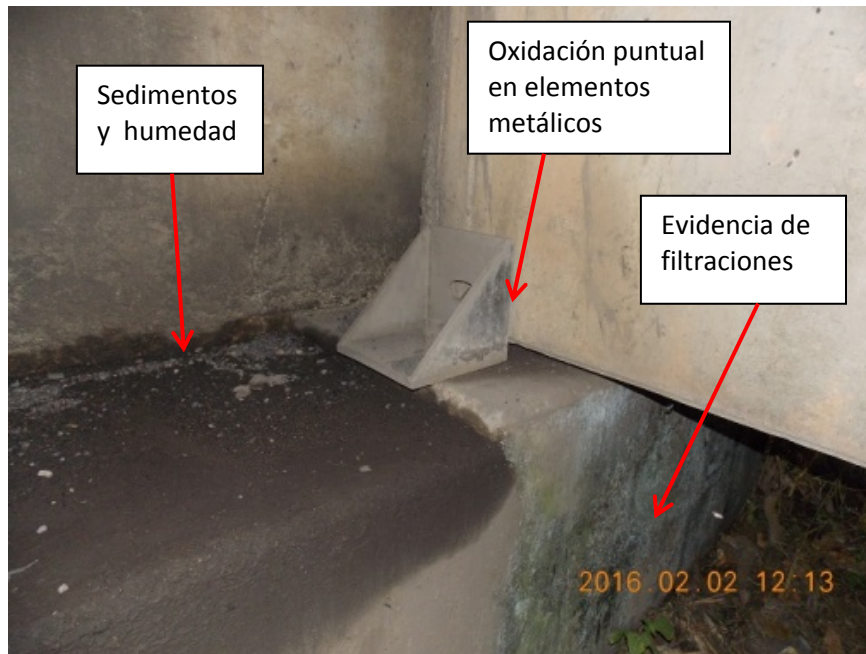
Figura 11. Presencia de sedimentos y humedad, oxidación puntual en elementos metálicos y evidencia de filtraciones en bastión 1.
