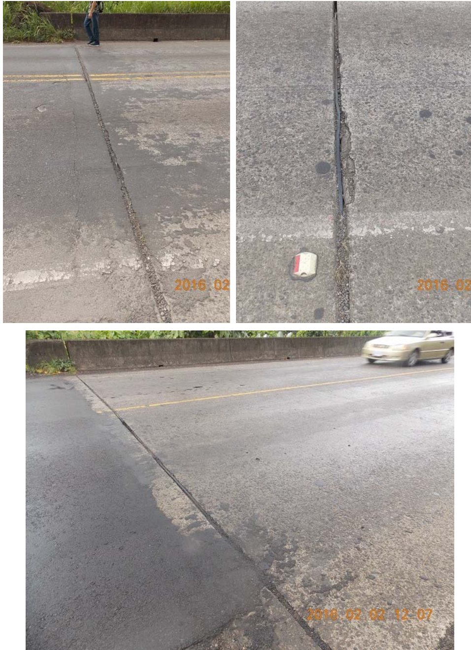
Figura 5. Obstrucción con asfalto y sedimentos de las juntas sobre los bastiones (fotos arriba a la izquierda y abajo) y deterioro del sello de la junta sobre las pilas (foto arriba a la derecha).
