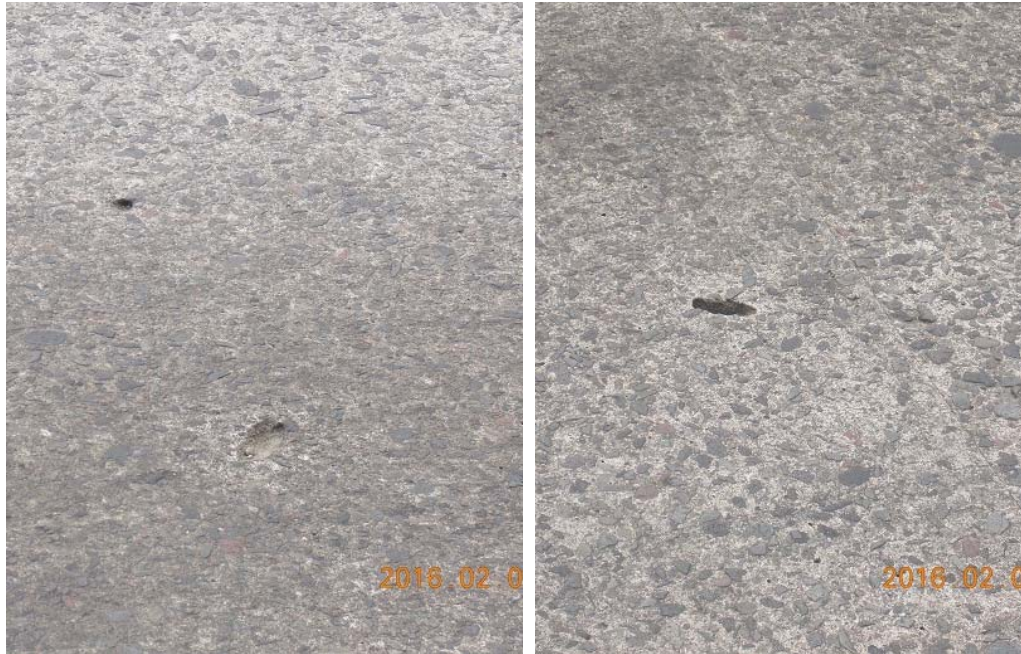
Figura 8. Desgaste generalizado y desprendimientos puntuales en la cara superior del tablero.
