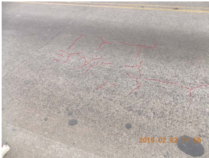
Figura 7. Agrietamiento y desgaste de la cara superior del tablero que funciona como superficie de rodamiento del puente.
