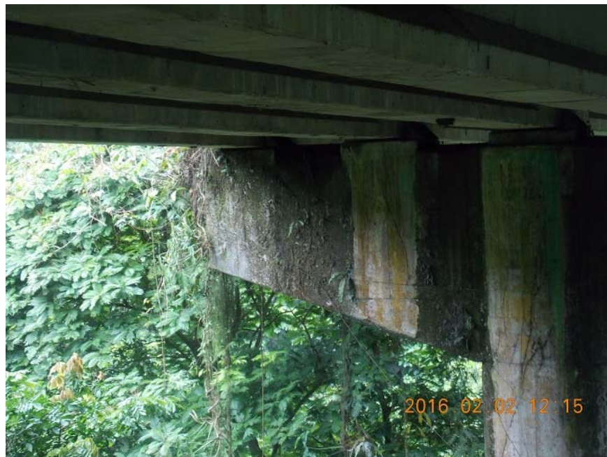
Figura 13. Evidencia de filtraciones y crecimiento de vegetación en pila 1.
