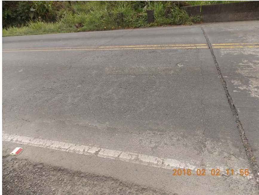
Figura 6. Agrietamiento en dos direcciones, desgaste y desprendimientos de agregado en la superficie de rodamiento del acceso 1.
