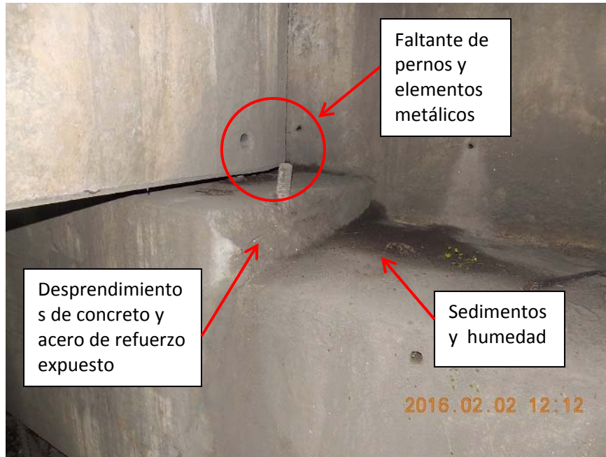
Figura 10. Faltante de pernos y elementos metálicos, desprendimientos de concreto en pedestal y presencia de sedimentos y humedad en bastión 1.
