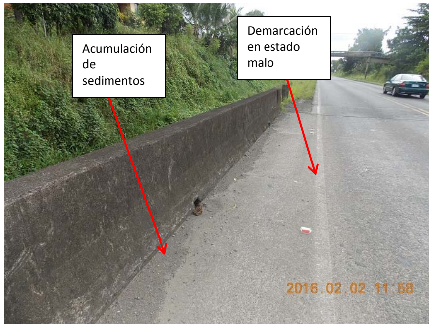
Figura 2. Ausencia de acera o bordillo de seguridad, demarcación horizontal en mal estado, acumulación de sedimentos y barrera vehicular cubierta con moho
