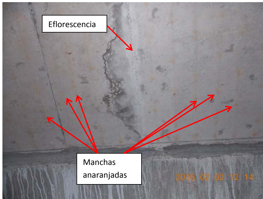
Figura 9. Eflorescencia y manchas anaranjadas en la cara inferior del tablero de la superestructura 1.
