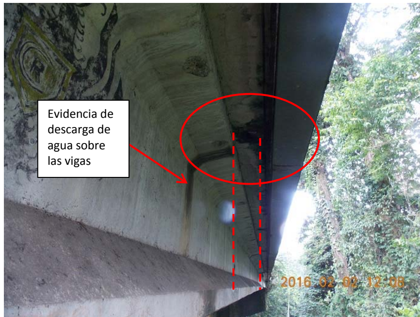
Figura 4. Ducto de desagüe sin tubo de extensión
