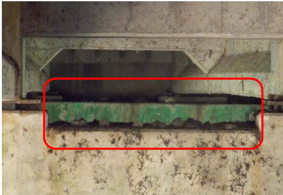
Figura 8. Piedras de río sobre viga cabezal de la pila 1 lo cual evidencia que el borde libre es menor al valor de 1,5m requerido por el MOPT.
