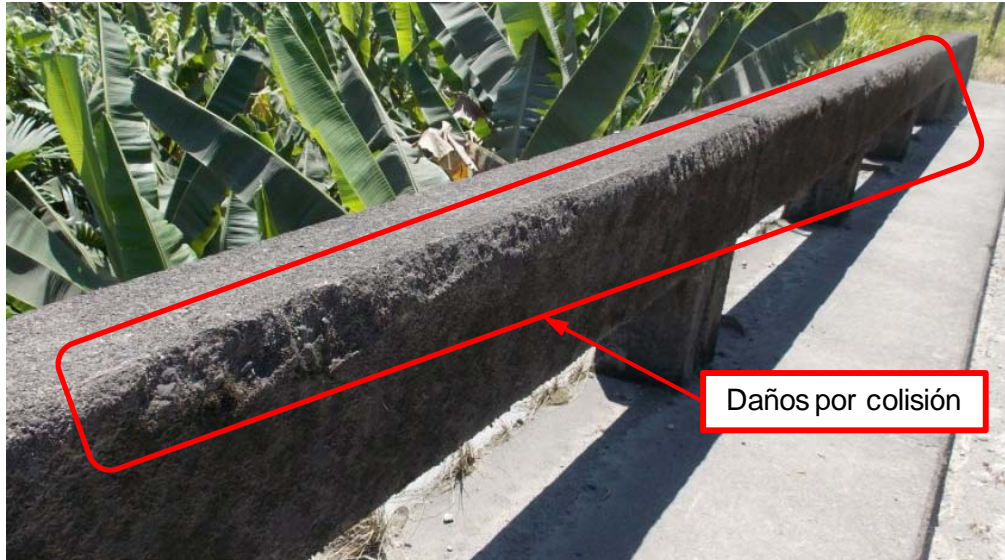
Figura 1. Barrera de contención vehicular dañada por impactos vehiculares así como con evidencia de no cumplir los requerimientos para las condiciones actuales de la ruta.
