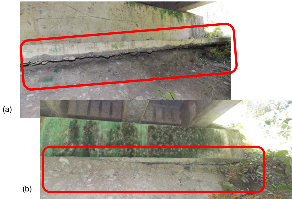
Figura 13. Manchas de humedad y erosión de los taludes frente a los bastiones: (a) Caso del bastión 2 (B2); (b) Caso del bastión 1 (B1).
