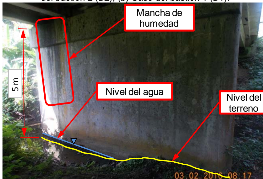
Figura 14. Mancha de humedad por filtración de agua a través de la junta de expansión, ausencia de elementos que eviten desplazamientos laterales de la superestructura sobre la pila durante un sismo, y nivel de socavación.
