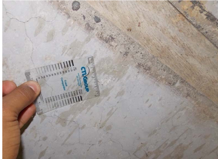
Figura 9. Agrietamiento en ambas direcciones con un ancho de grieta menor a 0,2mm y con intervalos menores a 50cm observado en la superficie inferior de la losa de concreto.
