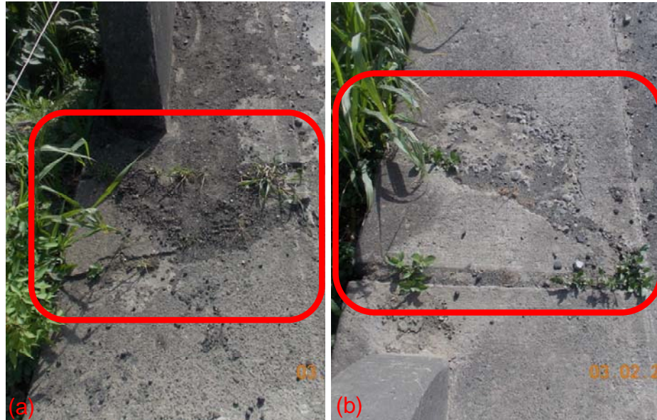
Figura 7. Daño en bordillos de seguridad norte de ambos accesos: (a) Sección norte del acceso 1; (b) Sección norte del acceso 2.
